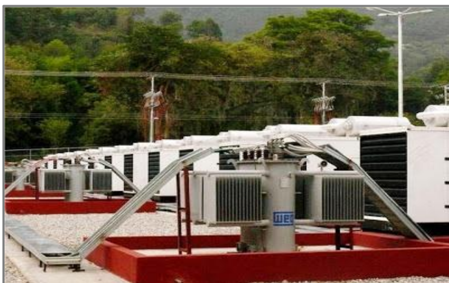
Imagen N° 69. Planta de Generación Distribuida Yorsiño Carrillo Torres, estado Mérida Fuente: Corpoelec
