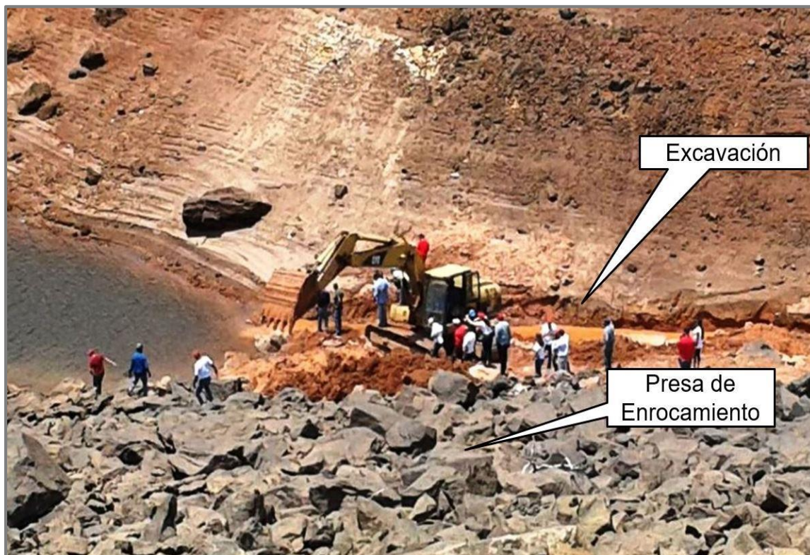
Imagen N° 87. Excavación al pie de la presa / Notas aclaratorias personales Fuente: Fuente: Red social twitter (@LMOTTAD) (07 de abril 2016)
