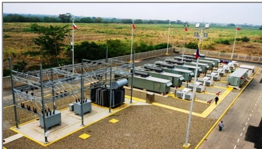
Imagen N° 68. Planta de Generación Distribuida Barúa, estado Zulia Fuente Corpoelec
