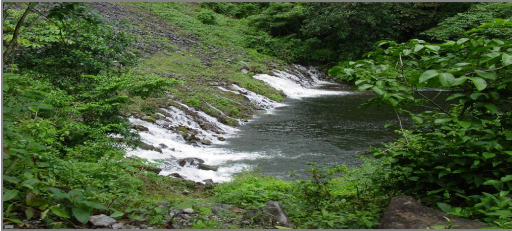
Imagen N° 21. Presa Las Claritas del Embalse Turimiquire Filtraciones en el Talud Aguas Abajo. Fuente: Ing. Diego Ferrer Fernández (†) (2003) 29
