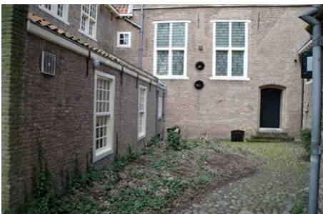
159 Westelijk deel van de zuidgevel van bouwdeel 4 met toegang tot de soepkeuken (ruimte 10p) en twee gereconstrueerde kruisvensters (1948).
