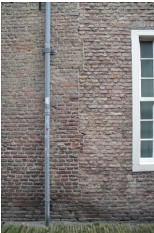
121 Vertanding in bouwnaad tussen bouwdeel 1 (rechts) en bouwdeel 2 (links).
