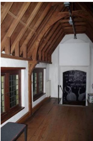
243 Ruimte 9p, de verbindingsgang, gezien in zuidelijke richting met doorgang naar de kapittelzaal. Zichtbaar is dat de gang tegen de buitengevel is aangebouwd.
