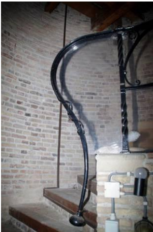
275 Bouwdeel 10. Smeedijzeren leuning bij de trap naar de omgang op de eerste verdieping.
