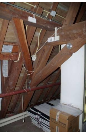
349 Kap bouwdeel 7. Bij dit juk is het korbeel waarschijnlijk hergebruikt. Het bovenin zichtbare jukbeen van het bovenste juk toont een ongebruikte pen-en-gatverbinding en is ook hergebruikt.
