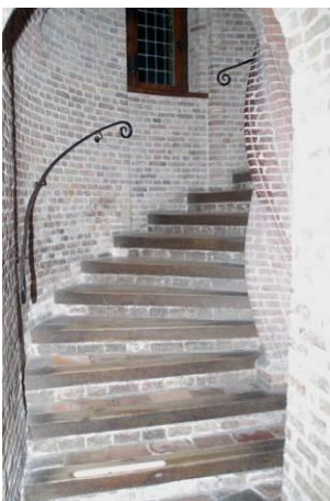
273 Bouwdeel 10. Onderste deel van de spiltrap dat nog uit de bouwtijd dateert, voorzien van gemetselde treden met houten opdektreden en spiraalvormig gemetselde trapspil.
