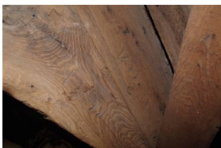
329 Kap bouwdeel 4. Gehakte montage-merken VCC (7) op de zijkant van een korbeldriehoek van de onderste jukken. Wat lager is gehakte graffiti met het jaartal 1868 te zien.
