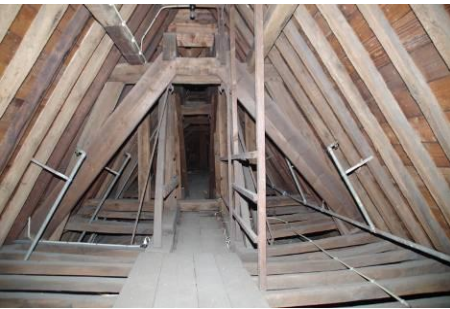
343 Kap Waalse Kerk. Overzicht bovenste jukken en ingebouwde constructie voor de dakruiter. Goed zichtbaar is de doorbuiging van de balken ter plaatse van de dakruiter. De schoorbalken zijn toegevoegd om het gewicht van de constructie beter af te voeren.
