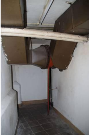
185 Ventilatiesysteem uit circa 1940, in het westelijk kelderdeel in bouwdeel 5.
