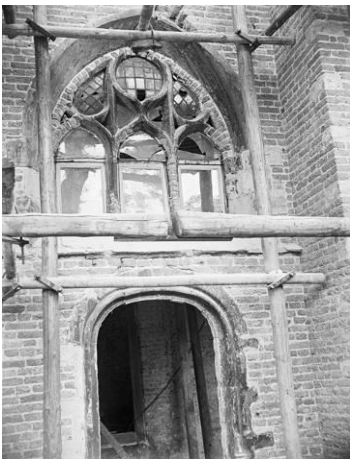
89 Travee aan de buitenzijde van de narthex met nog aanwezige tracering en gotische poortdoorgang. (Herkomst: RCE, beeldbank)
