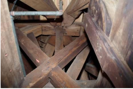
302 Kap Waalse Kerk. Detail kapconstructie ter hoogte van de dakruiter met rechts de katrol voor het klokkentouw.
