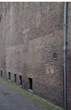
155 Grote herstelling in het metselwerk ter hoogte van de soepkeuken (ruimte 10p) en sporen van een ontlastingsboog van een oudere gevelopening.
