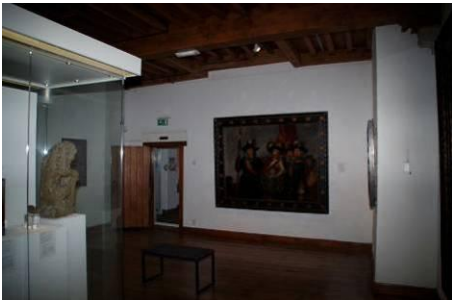
194 Ruimte 16p. Aan de westzijde in de zoldering aanwezige raveling van verdwenen stookplaats.
