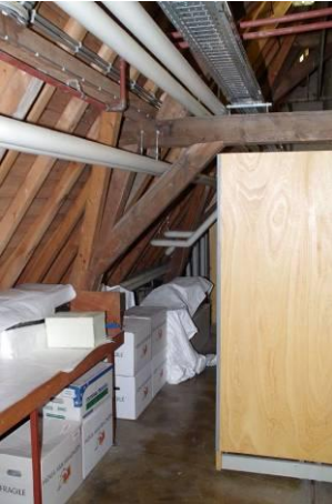
348 Kap bouwdeel 9. Detail onderste juk. Het korbeel is aan de onderzijde gepend in het jukbeen, in tegenstelling tot de oudere kapconstructies in het complex.
