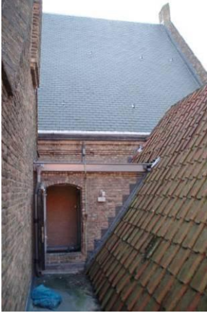
246 Zakgoot tussen de zijgevel van bouwdeel 9 (links) en het dak van bouwdeel 7, gezien in zuidelijke richting met op de achtergrond het met leien gedekte dak van bouwdeel 11.
