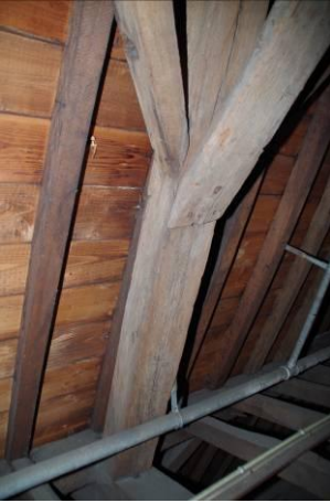
342 Kap Waalse Kerk. Detail gespijkerde verbinding korbeel op jukbeen. De spijkers zijn in driehoeksvorm geplaatst, met bovenin de spijker met de grootste kop.
