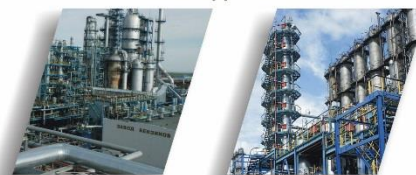
УСТАНОВКА КАТАЛИТИЧЕСКОГО КРЕКИНГА
