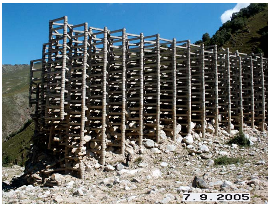
Рис. 4. Плотина на р. Герхожан-Су (Северный Кавказ, Россия), построенная в 1987-1999 и разрушенная селем через 2 месяца после окончания строительства.
