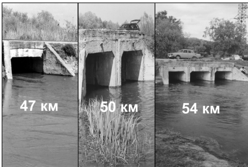
Рис. 1. Оставшиеся после строительства автотрассы водотоки: (1 - 47 км, 2 – 50 км, 3 - 54 км автотрассы)
