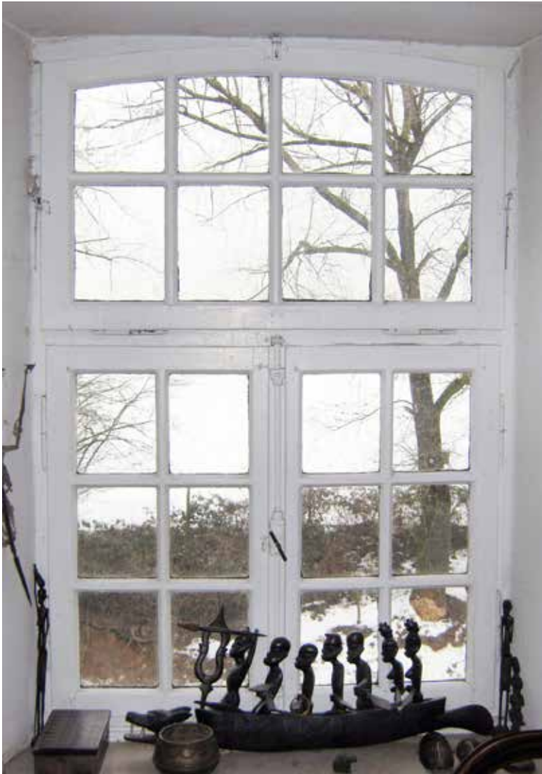
12. Baskülever- schluss der zwei Flügel im unteren Bereich des Fens- ters. Foto: Werner von Schorlemer, LVR-ADR.
