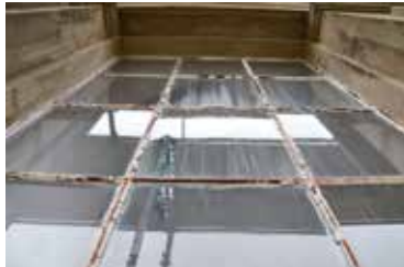
5. Essen-Bredene, Villa Hügel, Belvedere. Schäden an Rahmen und Glas. Foto: Susanne Conrad, LVR-ADR.
