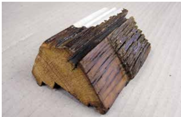
6. Der Schein trügt: ein oberflächlich kaputter Wetterschenkel von ca. 1900, in der Grundsubstanz kerngesund und durch „Gesundschneiden“ wieder revitalisiert. Foto: Johannes Mosler.
