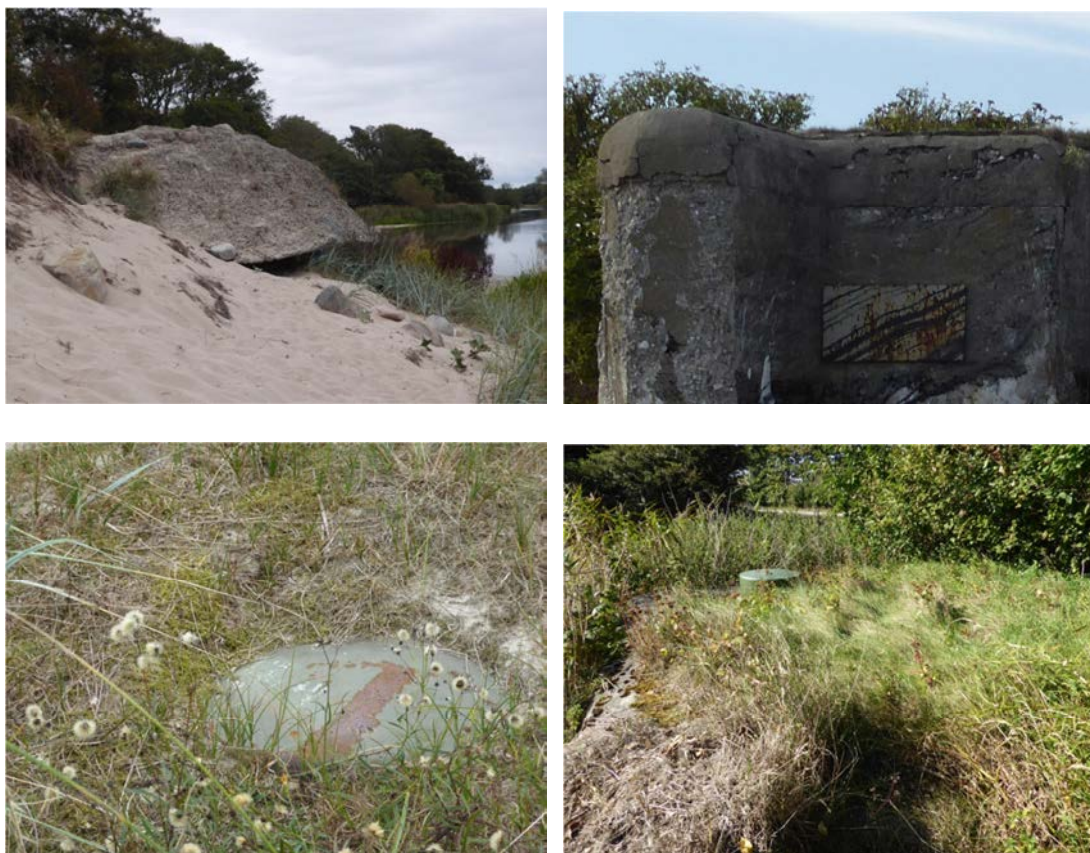
Fotografierna visar exempel på de skador som har förekommit. Överst till vänster ses ett exempel på erosion, bilden är tagen i Ystad där dessa skador också var mest framträdande. Nästa bild visar exempel på vittrad betong och även detta fotografi kommer ifrån sydkusten. Omfattningen av erosionsskador har varit relativt jämnt spritt mellan delsträckorna och ingen kuststräcka eller något delområde utmärker sig i inventeringen. Nedan till vänster ses ett översandat värn följt av ett övertorvat dito. Generellt var övertorvning den vanligaste skadan som noterades.
