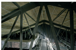
Obr. 4 A, B. Praha 8-Karlín, čp. 283, Hudební divadlo v Karlíně. Konstrukce krovu (foto P. Havlík, 2010).
