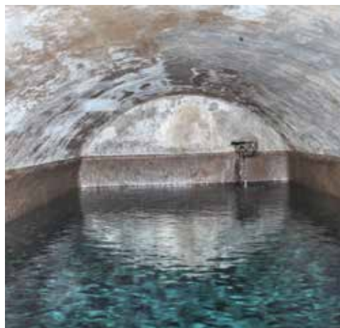
Interior de uno de los dos depósitos de distribución de agua, todavía en estado de uso.
