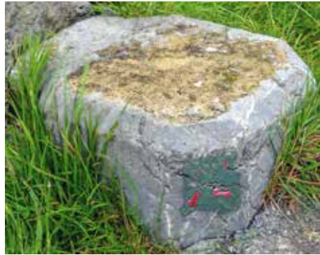
Estado actual de las bases frontales de las embocaduras izquierda y derecha del camino de acceso.
