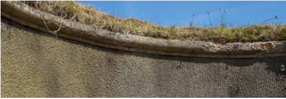
Cordón del revestimiento del parapeto de uno de los asentamientos circulares de la Obra de la Derecha.
