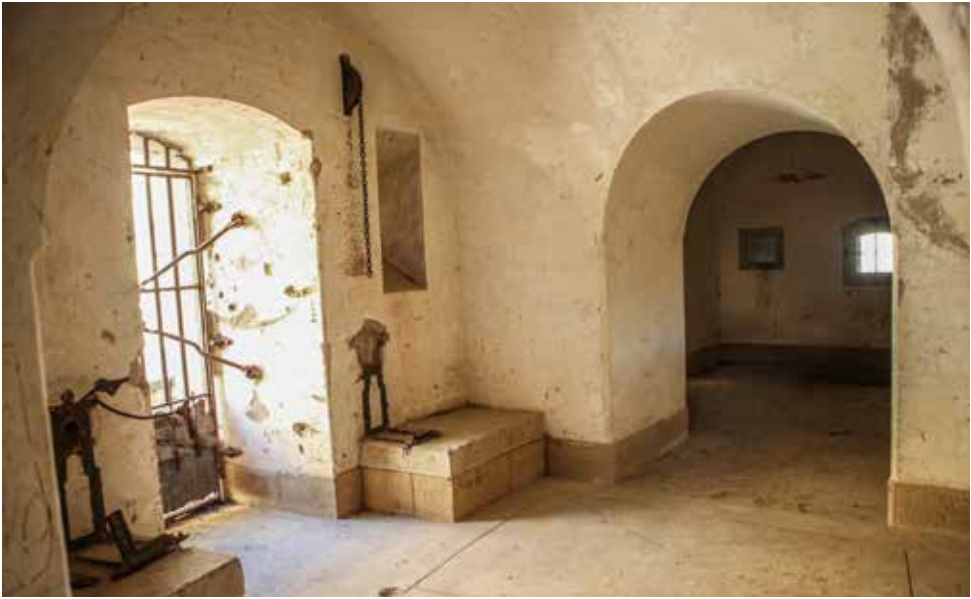
Estado actual de la puerta de guerra (a la izquierda) de la caponera de gola, con los elementos conservados del puente levadizo. A la derecha: casamata oriental de la caponera.
