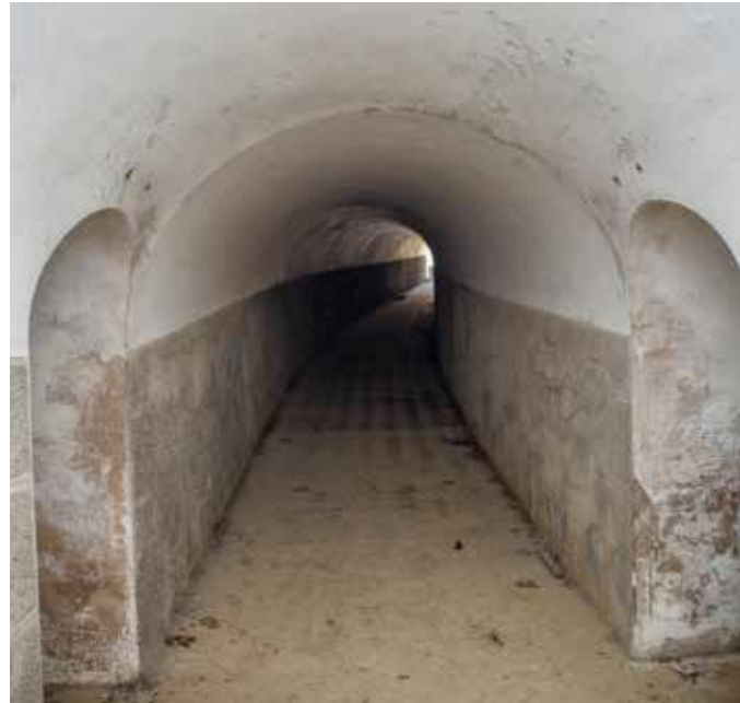
Caponera sureste. Poterna de comunicación (5) con el patio oriental. En primer plano los accesos a los repuestos de munición (2).
