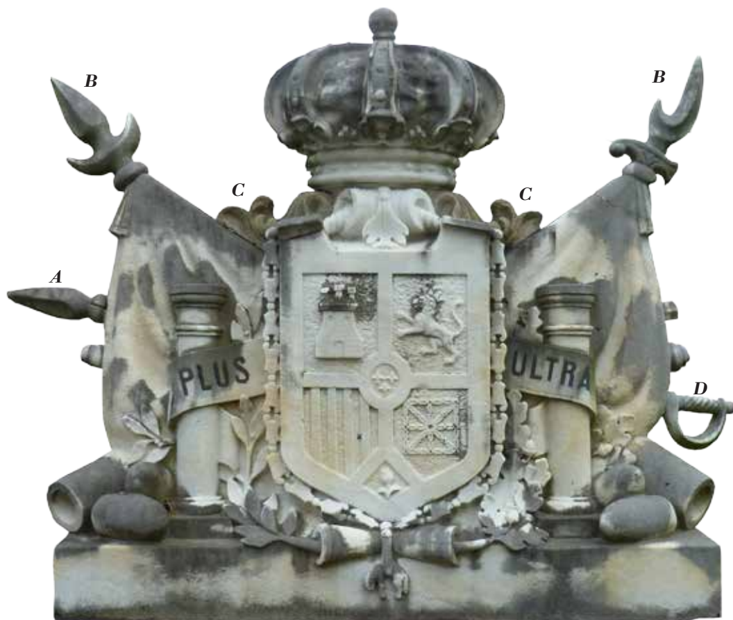
Estado actual del escudo, con indicación de piezas no originales, principalmente lanza (A), las desproporcionadas moharras de las banderas (B), adornos (C) y espada (D).
