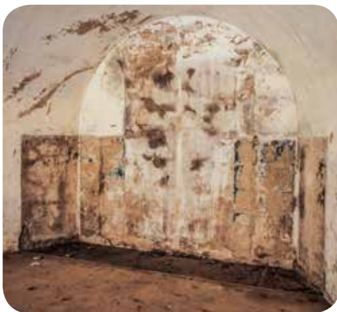
Vestigios de un armario, previsiblemente de madera. Se encuentra en la bóveda oriental de la batería acasamatada, correspondiendo a la planta superior del depósito de distribución de munición.
