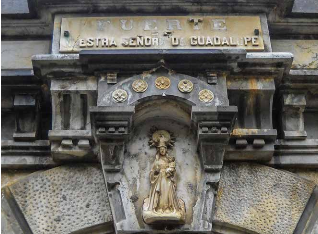
“Fuerte nuestra señora de Guadalupe”, sobre la imagen de la Virgen en la clave de la puerta principal. Se encuentra en mal estado, al faltar varias letras en relieve.
