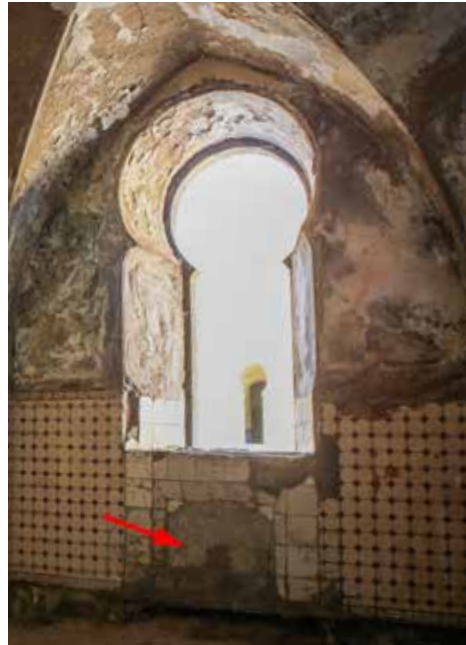
Chimenea cegada en el comedor del pabellón del gobernador del Fuerte, bajo la ventana. Posiblemente dispone de un tubo lateral para la salida de humo tal y como se aprecia en otra dependencia.
