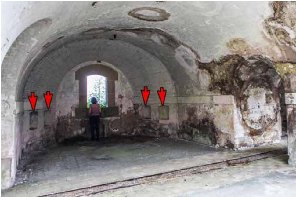
Localización de los cuatro repuestos de mano para proyectiles del Cañón de Hierro Entubado "Ordóñez" de 15 cm, en el frente norte de la batería acasamatada en la Obra de la Izquierda. Las casamatas en reserva (cañonera cerrada) no disponen de repuestos de mano.
