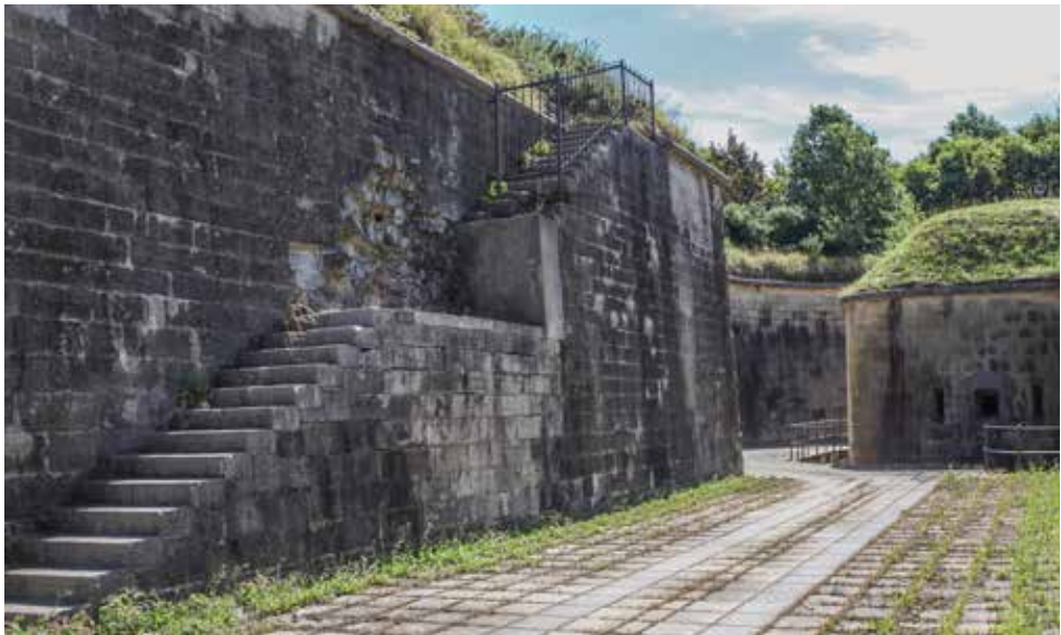
Escalera de contraescarpa situada en proximidad de la semicaponera oriental (4). El sector de escalera que falta fue volado por el Ejército en el año 1980.
