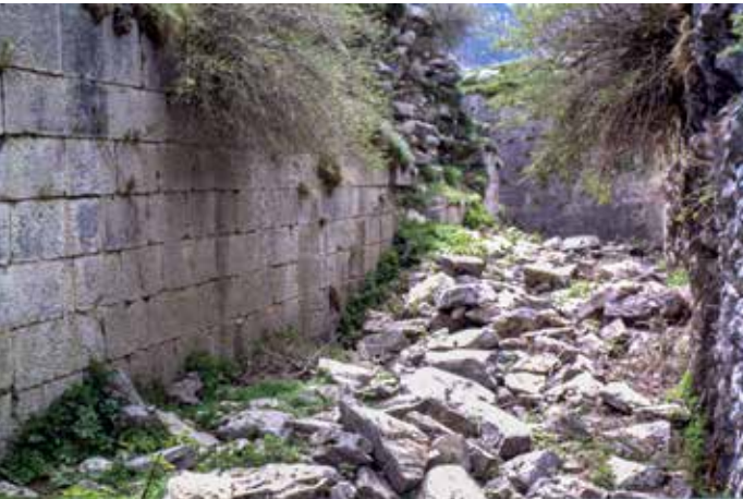
△ 3 Batería de La Sagüeta en Canfranc (Huesca). A la izquierda la escarpa y a la derecha la contraescarpa.
