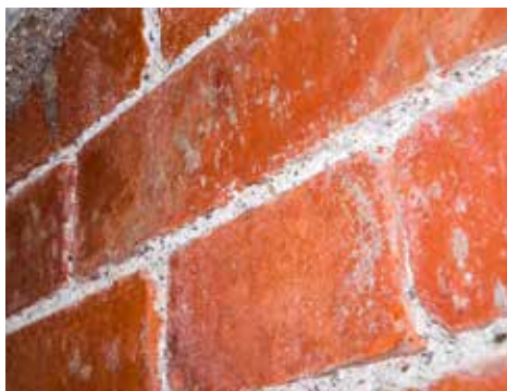
Muro de ladrillo en los pabellones de oficiales de Infantería, en la Obra de la Izquierda.
