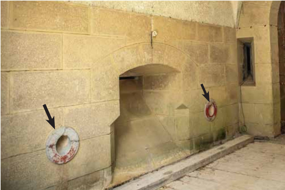
Boca exterior de dos de los cuatro tubos lanzaproyectiles que defienden el foso de la puerta principal, dispuestos a ambos lados de un matacán.
