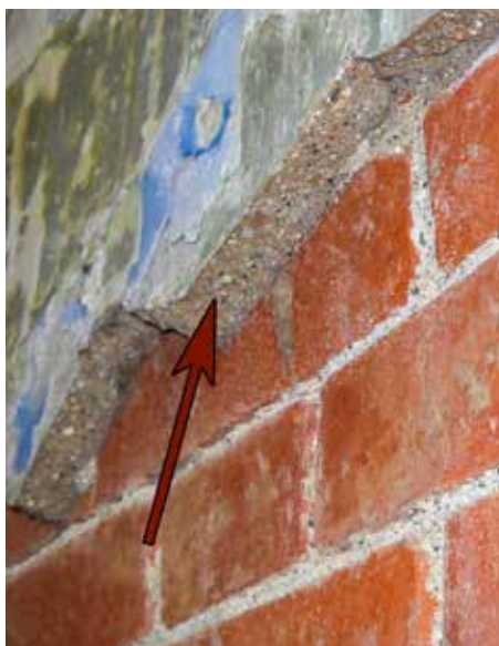
Enfoscado de un muro de ladrillo en los pabellones de oficiales de Infantería en la Obra de la Izquierda. Se aprecia su considerable grosor, superior a los 2 cm.
