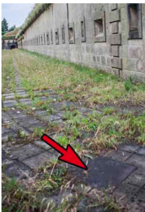
Uno de los registros actuales de la red de saneamiento a su paso por el foso
