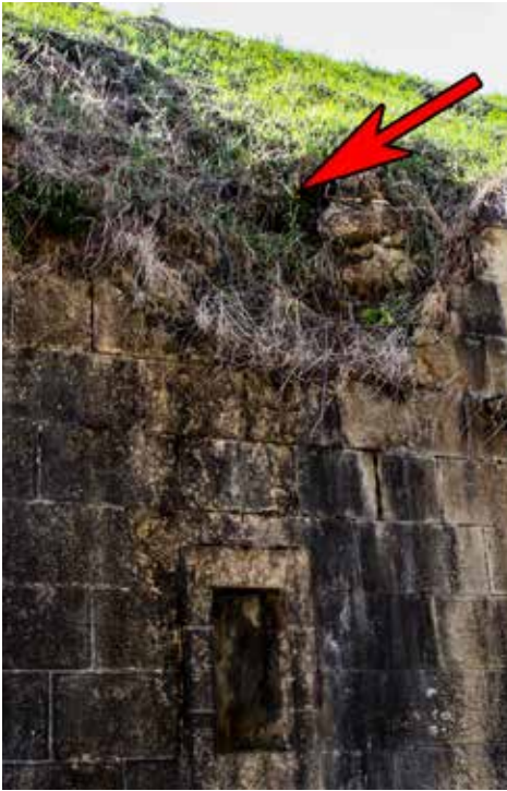
Posible impacto de un proyectil de artillería en la zona superior de la galería de escarpa. Se aprecia cómo la falta de cordón propicia la humedad y suciedad de la sillería.
