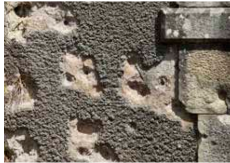
Impactos de proyectiles en el patio de infantería (arriba) y en el acceso a un emplazamiento circular de la Obra de la Derecha.
