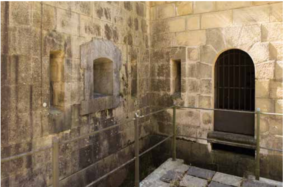
Puerta de guerra o "salida al foso" de la semicapenera oriental (2) , cercana a su cañonera.
