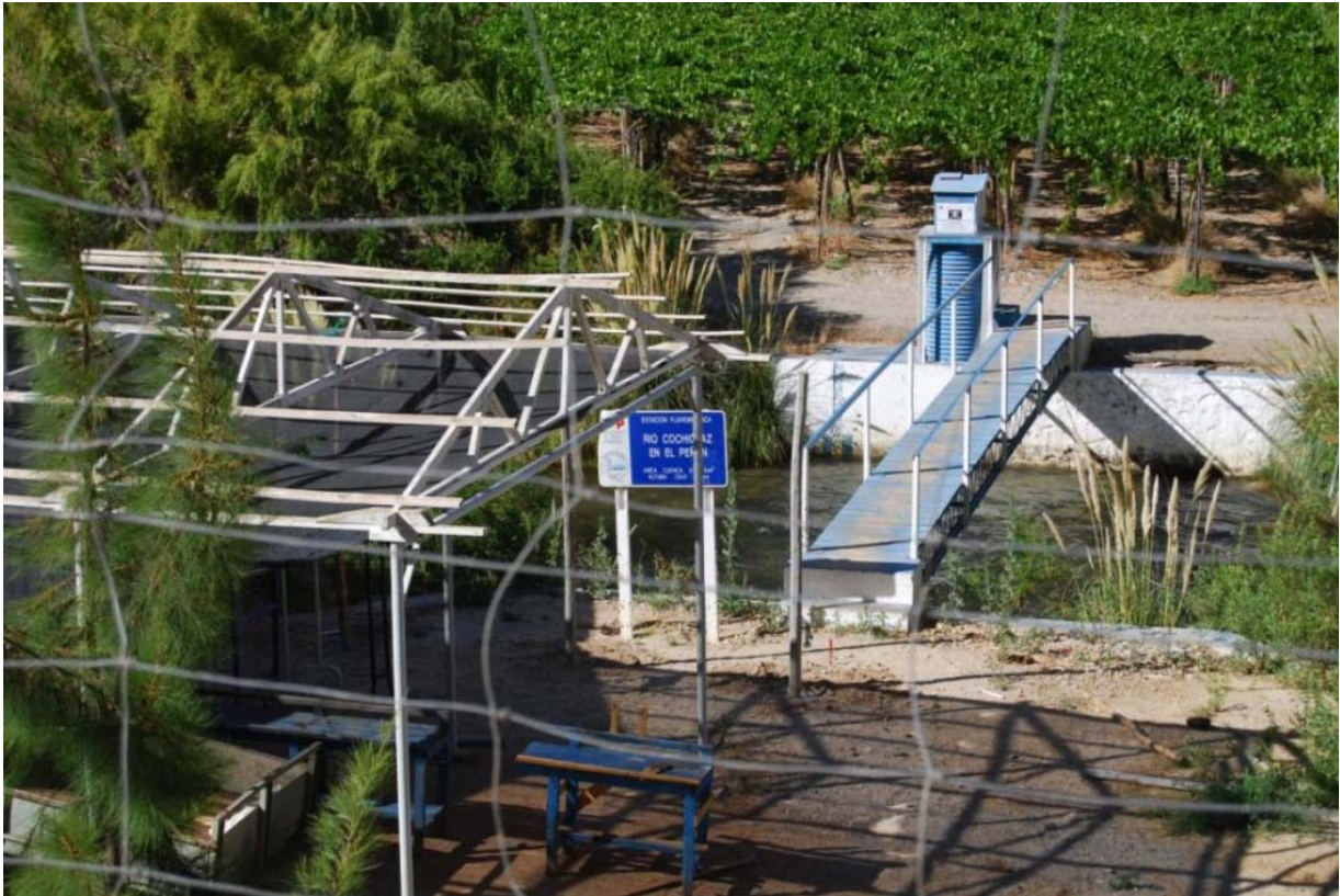
FIGURA 8.2-4 ESTACIÓN FLUVIOMÉTRICA RÍO COCHIGUAZ EN EL PEÑÓN
