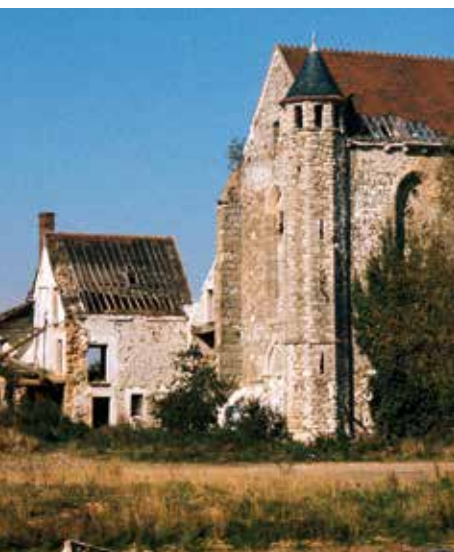
Le bâtiment de Bièvre, en partie écroulé, témoigne du piteux état du site au début des années 1970.
