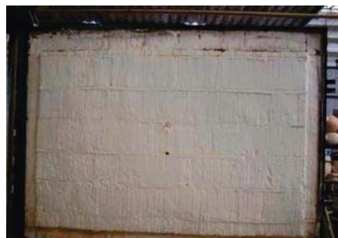
ผนังเตาไฟเบอร์ที่อยู่ในสภาพดี พร้อมใช้งานช่วยป้องกัน การสูญเสียพลังงานความร้อนได้มาก
