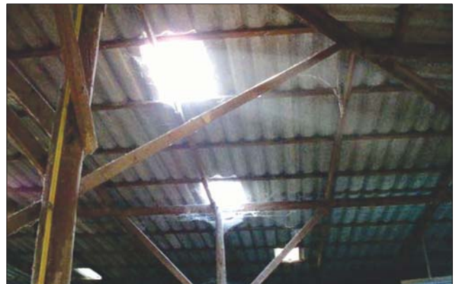
หลังคาโปร่งแสงช่วยเพิ่มแสงสว่างตามธรรมชาติ โดยไม่ต้องเสียค่าไฟฟ้า ทั้งยังให้ค่าความเข้มแสงสูง
