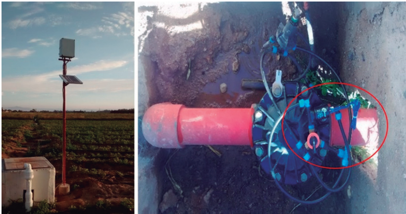
Figura 7. Nodo ruteador instalado, muestras de la instalación de la válvula solenoide de acción eléctrica
