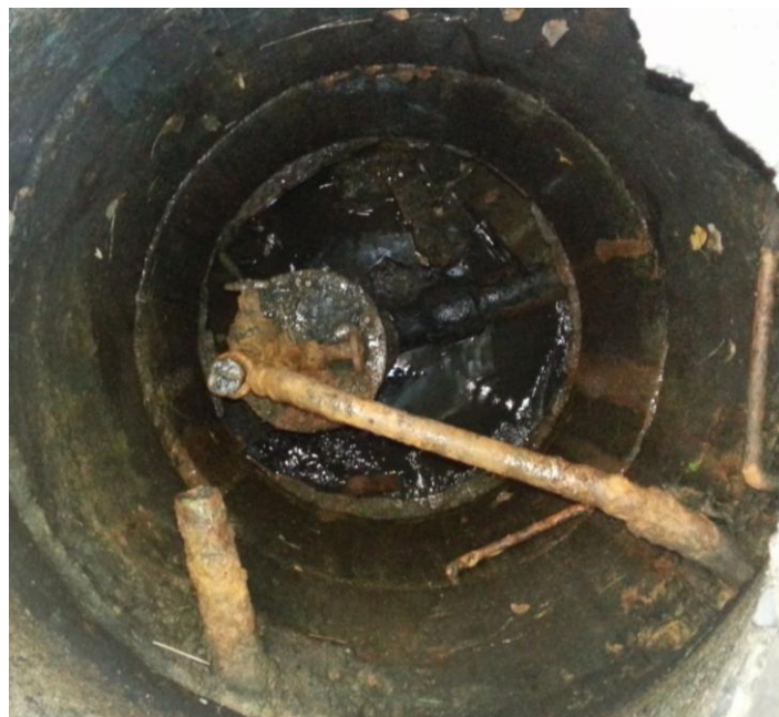
Рис.21 – Коррозия труб в водопроводном колодце
