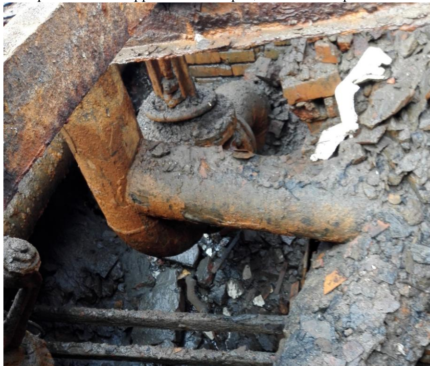
Рис. 18 – Коррозионные повреждения водопровода, постоянно находящегося в затопленном состоянии.
