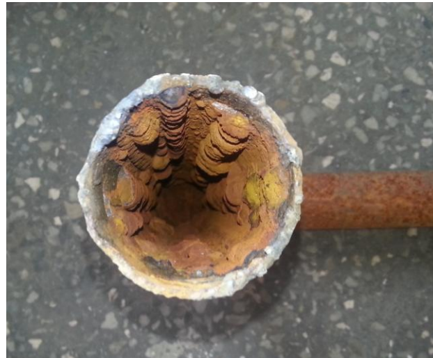
Рис.20 – Микробиологическая коррозия внутренних стенок трубы
