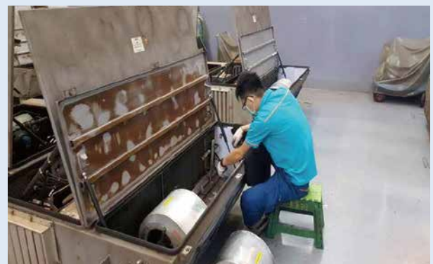
送風扇接頭改善 Improve fan connector
