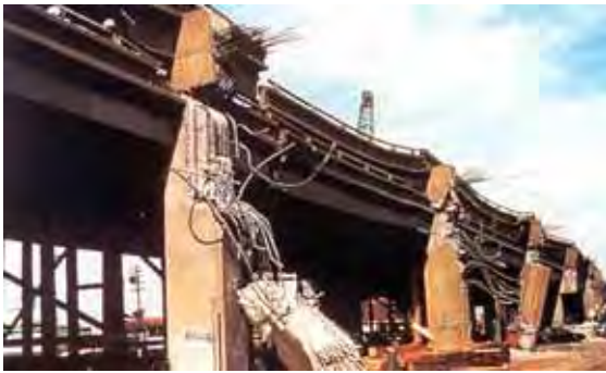
شكل D.1c تصدع وهدم الجسور بسبب الزلازل 1993, Montgomery
