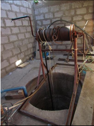
Pozo en caseta, predio San Basilio, Pica (P29)
