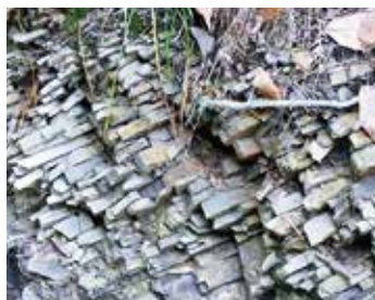
図8 板状に割れる泥岩
