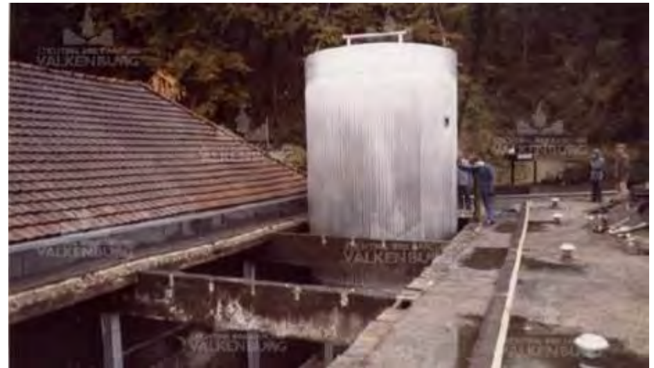
Plaatsing van een silo in 1985 in een van de hallen aan de zuidzijde van het terrein (bron: Beeldbank gemeentearchief Valkenburg LE-0267).
