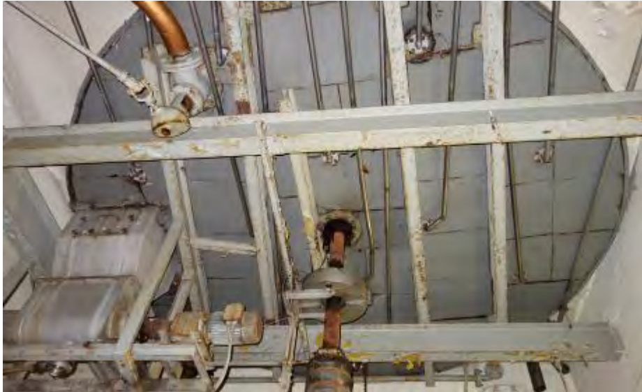
Onderzijde van de ketel in de noordwestelijke hoek van de ruimte.
