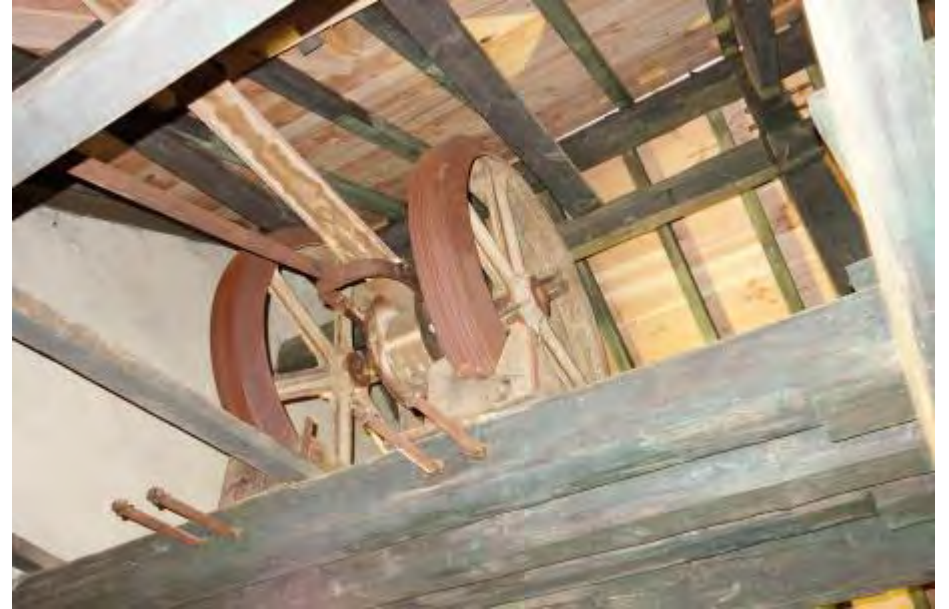
Detailopname van de aandrijving van de lift aan de zuidzijde van de zolderverdieping.
