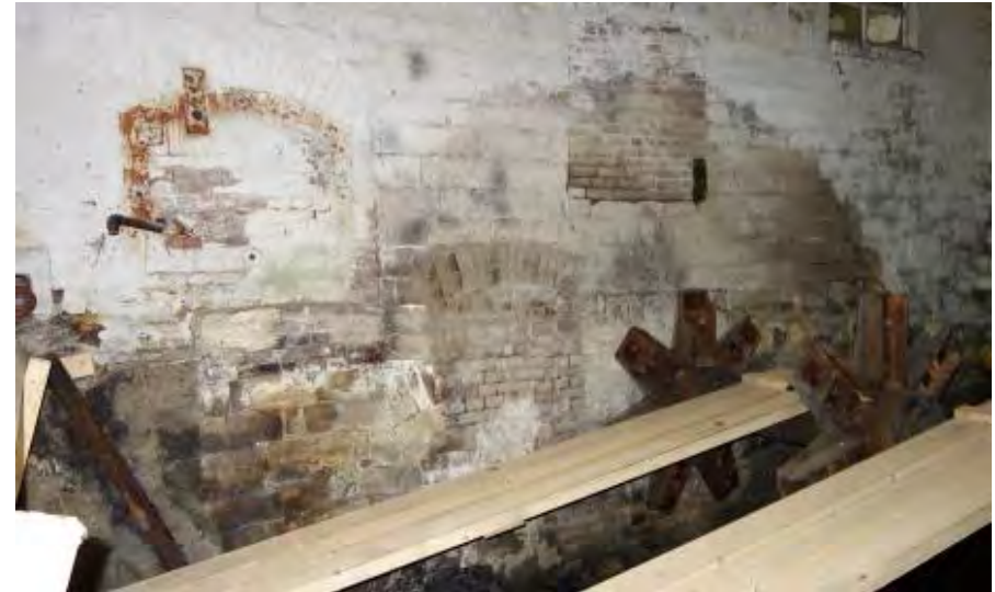
Detailopname van de oude bevestigingspunten van de verschillende raden in de zuidmuur van de ruimte.
