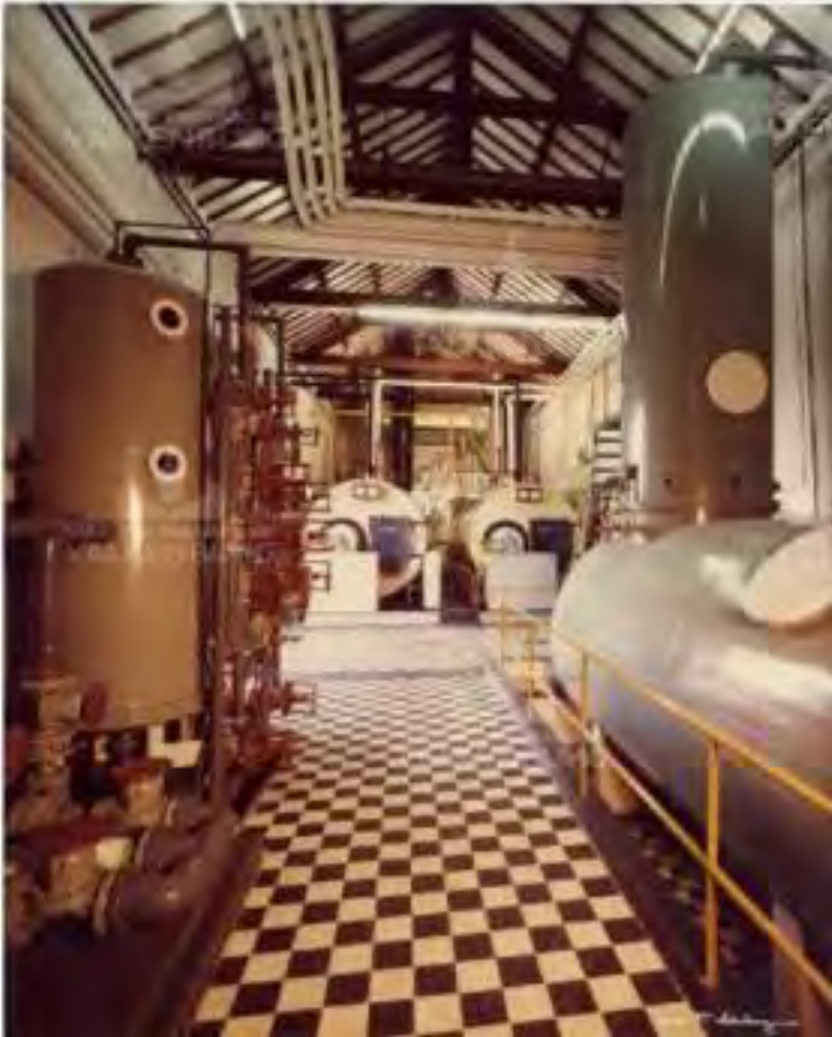
Het ketelhuis in 1971. Op de achtergrond de twee gastestookte stoomketels. Op de voorgrond de wateronthardingsinstallaties (bron: Beeldbank gemeentearchief Valkenburg LE-0058).
