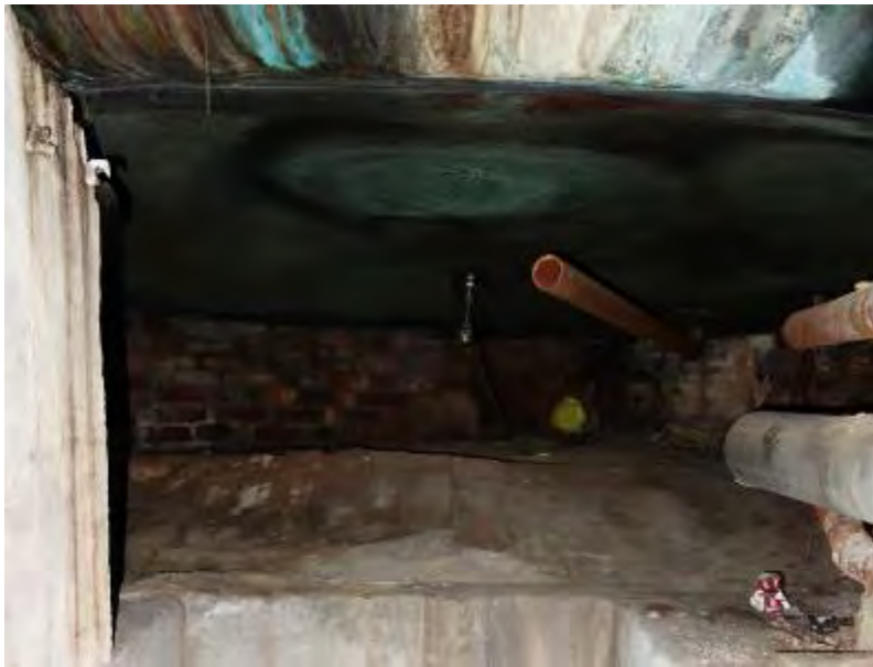
Onderzijde van de ketel met fundering in de noordoostelijke hoek van de ruimte, achter de gebogen wand.
