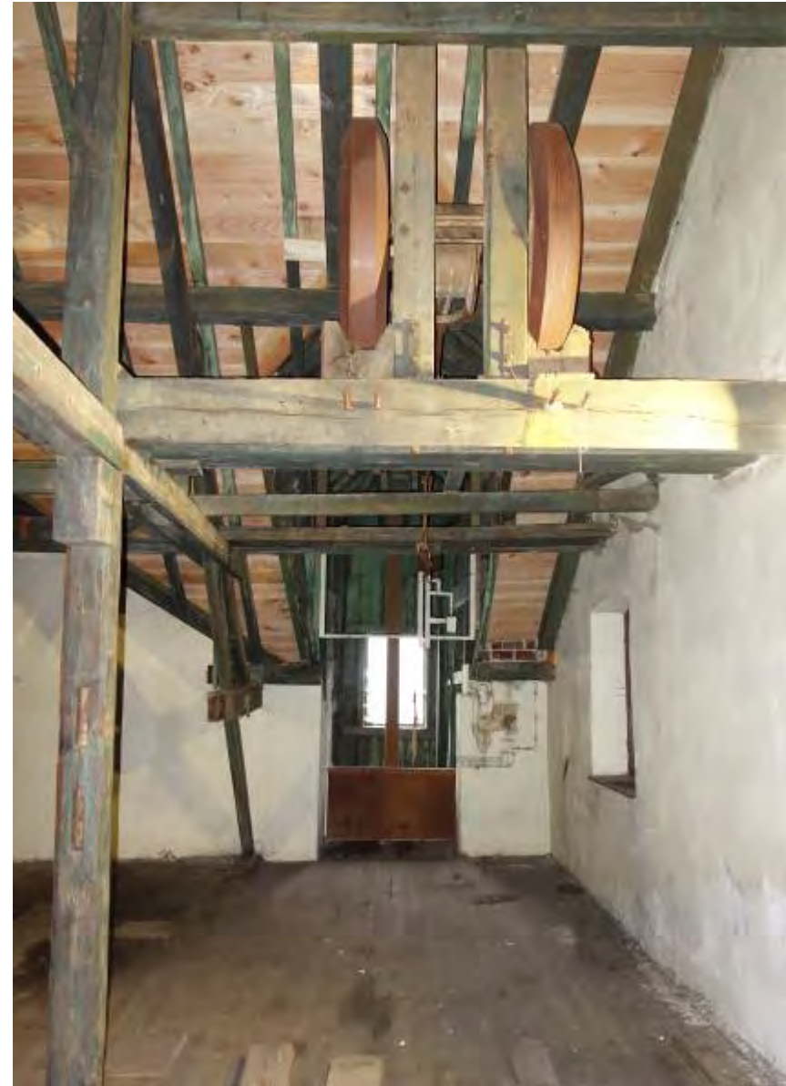
Detailopname van de aandrijving van de lift aan de zuidzijde van de kapconstructie
