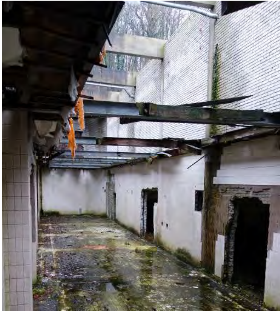
Oostelijke deel van de kelder onder de fabriekshal uit 1964, gezien richting het zuiden.
