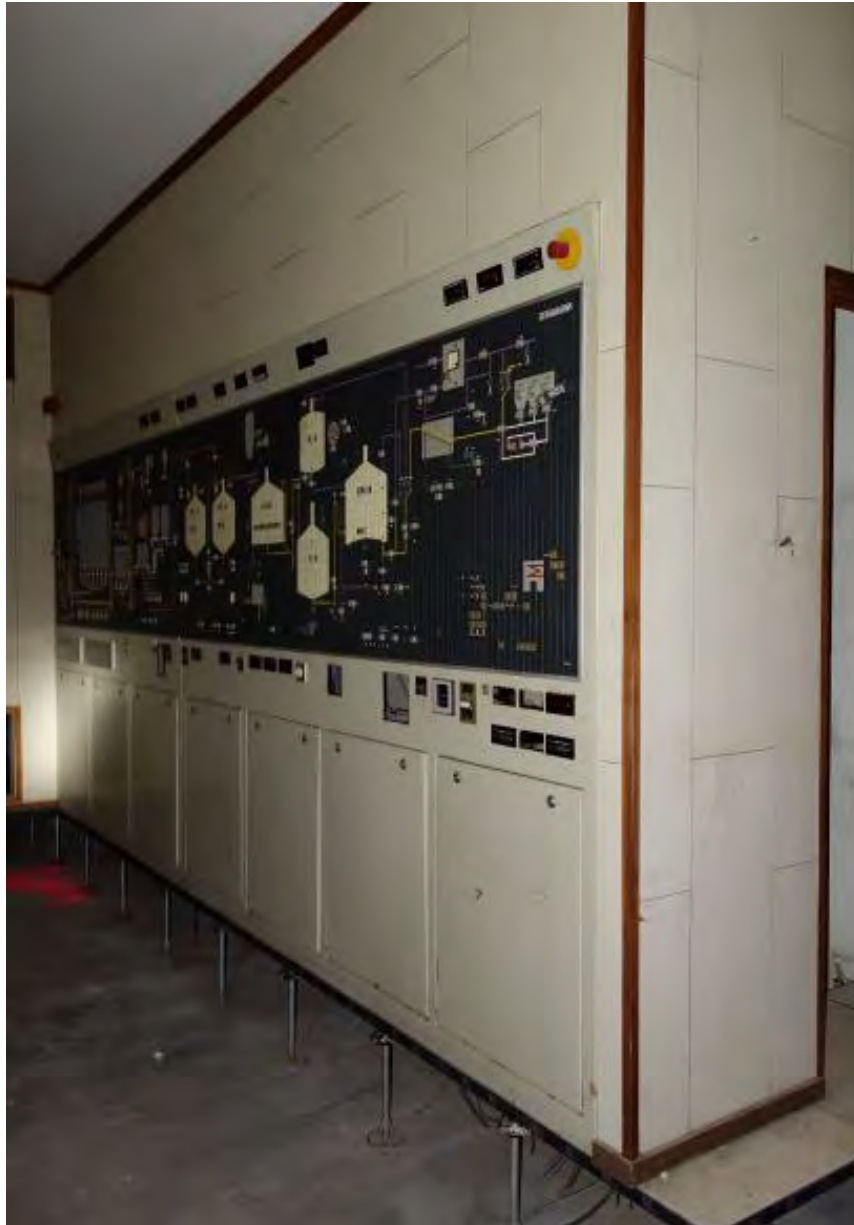
Detailopname van het Bischof computer system 5000 in de noord ruimte 1.1.
