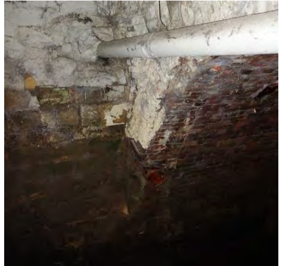
Detailopname van de aansluiting van de overkluizing op de kademuur van mergel.
