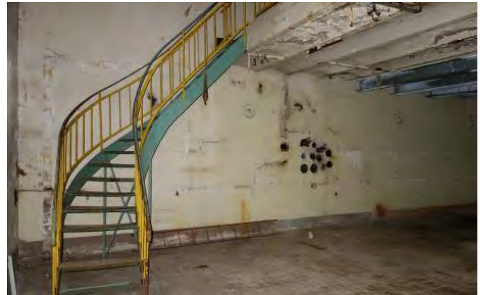
Ruimte 1.2 gezien richting het oosten met de trapopgang naar de tweede verdieping.
