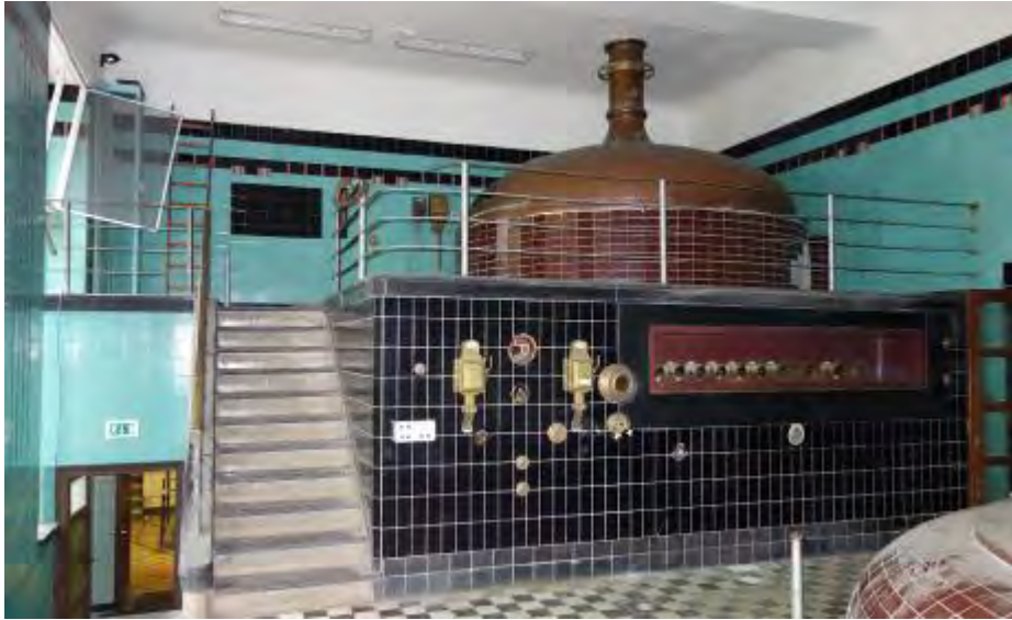
Ruimte 1.1 gezien richting het noordwesten met de tussenverdieping waar een van de twee ketels is opgesteld.
