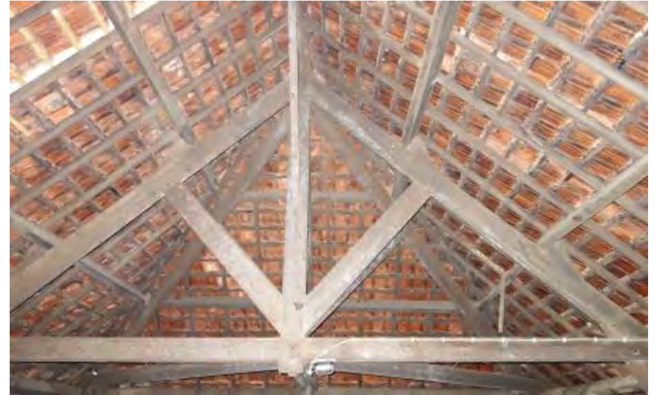
Westelijke deel van de kapconstructie boven de Schwankhalle , gezien richting het westen.
