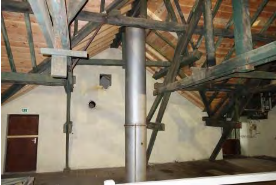
Zolderverdieping met zicht op het T-dak aan de oostzijde van de kap.
