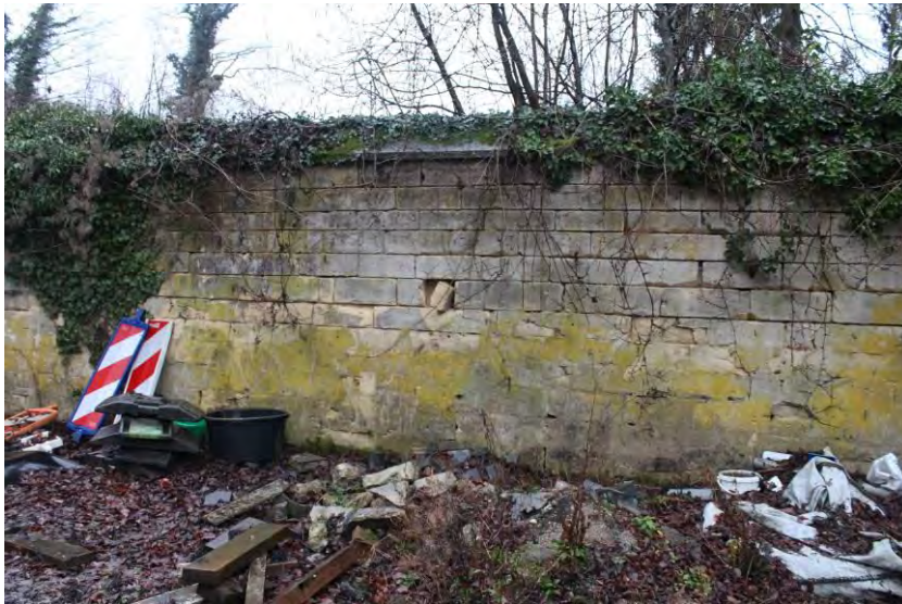
Muur op de grens van het terrein van de brouwerij en de voormalige wasserij, gezien vanuit het oosten.
