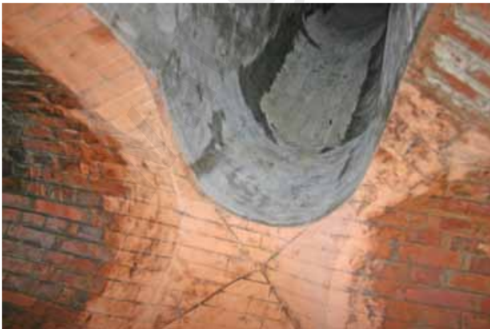
Fig. 70. Obra 25. Cruce de las bóvedas de la galería principal (de ladrillo en este sector) y de acceso al refugio (de hormigón). Corresponde al punto W del plano.
