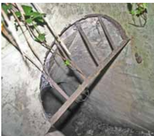
Fig. 56: Obra n. 6. Restos del cierre mediante verja de los pozos de tirador. Se ha conservado solamente la parte fija que cierra el sector superior,
