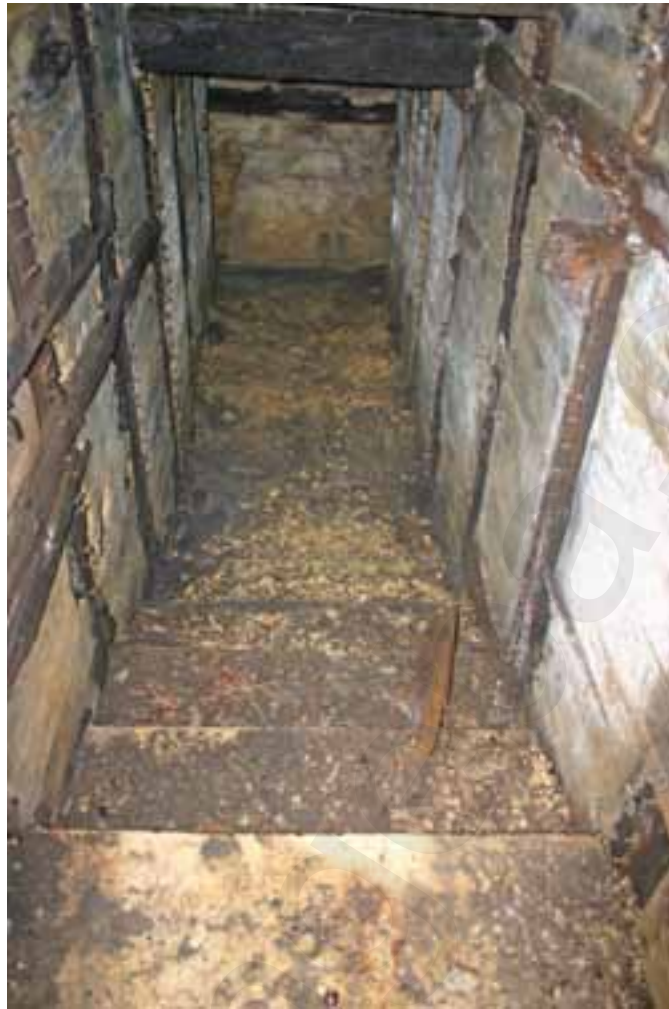
Fig. 42: Almacén de munición de la obra n. 2, visto desde su acceso. Mantenía el encofrado, pero actualmente está quemado, pudiendo observarse los clavos que salen de la madera chamuscada.
