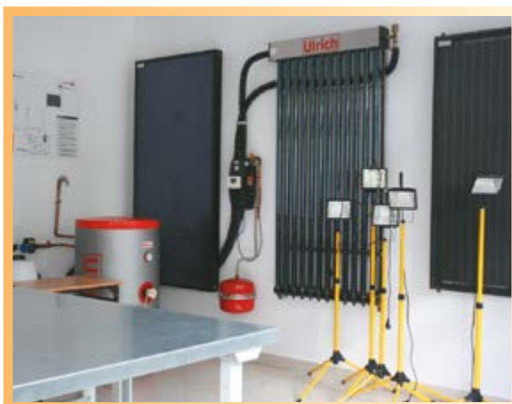
Pracownia techniki grzewczej
