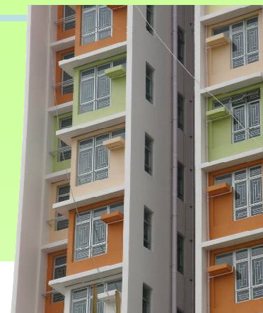
長沙灣邨為試用此設計的先導項目 Piloted in Cheung Sha Wan Estate
