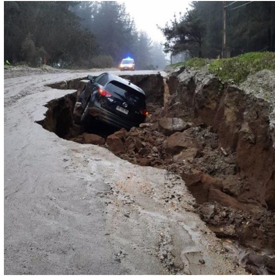
-Socavón en Avenida Principal en Horcón, comuna de Puchuncaví. Vehículos afectados.
