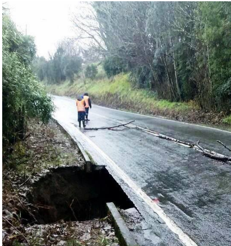
18 de julio de 2015: Deslizamiento de suelo y roca en el camino de ingreso a Maicolpué, comuna de San Juan De La Costa. Provincia: Osorno.
