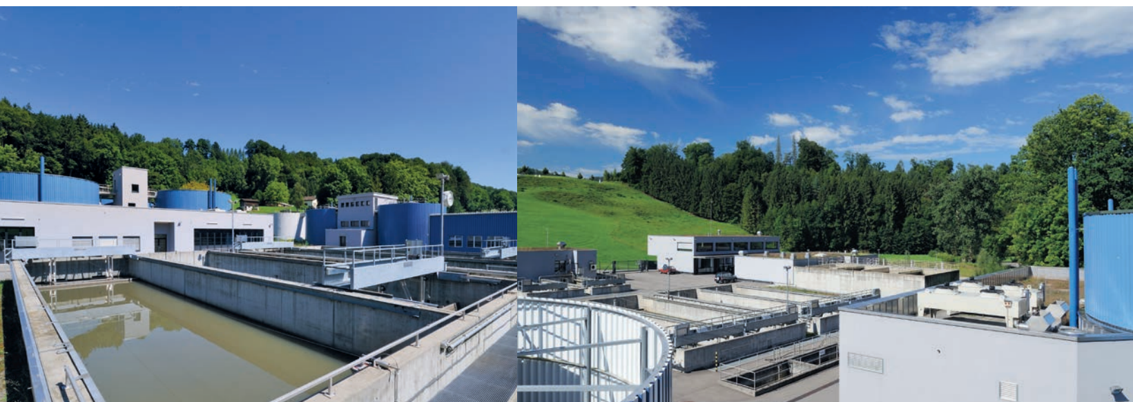
Jahrelang war die ARA Oberglatt überlastet. Die Industriebetriebe hatten zu geringe Frachtangaben gemacht. Für den neuen Ausbau wird auf die Angaben über die Bevölkerungsentwicklung abgestellt.
