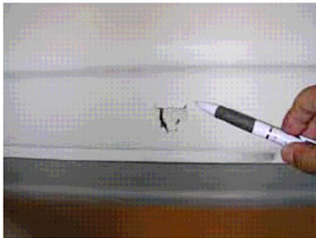
圖 1.12-3 天花板穿孔損害
