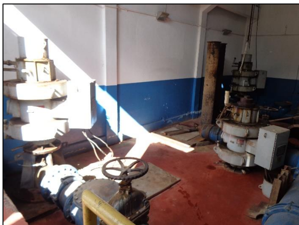
Foto 7. Elevatória de Água Bruta Itapecerica
