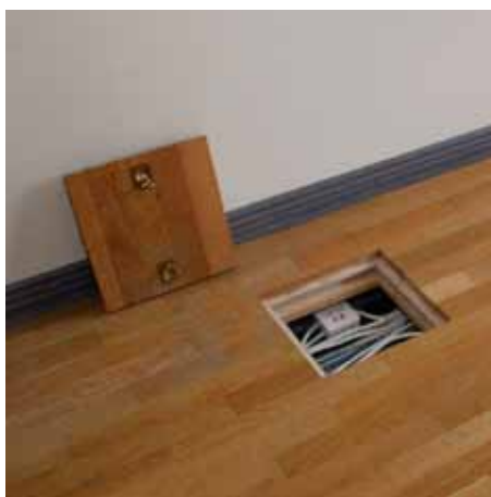
Toisen kerroksen huoneen 213 parkettilattian alle on roilotettu sähkökaapeleita 1987-1991.
