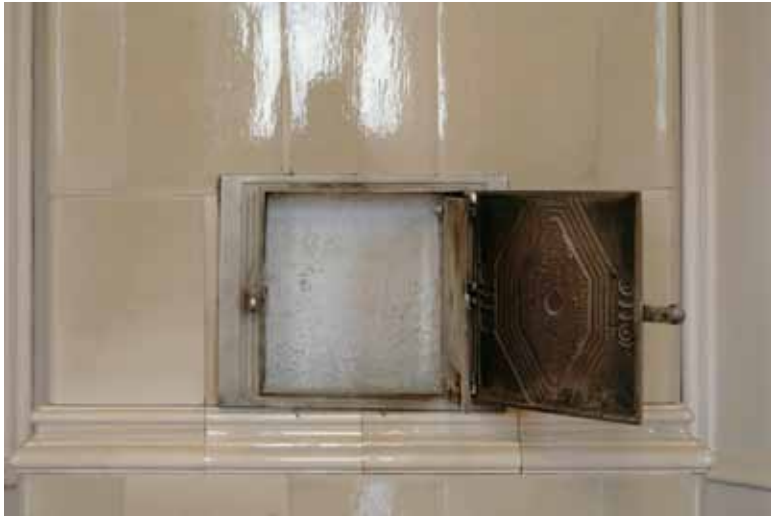
Jottei tulihormien kautta tulisi sisäilmaan likaa, on hormit suljettu. Kuvassa on 3. kerroksen toimistohuoneen 314 uuni.
