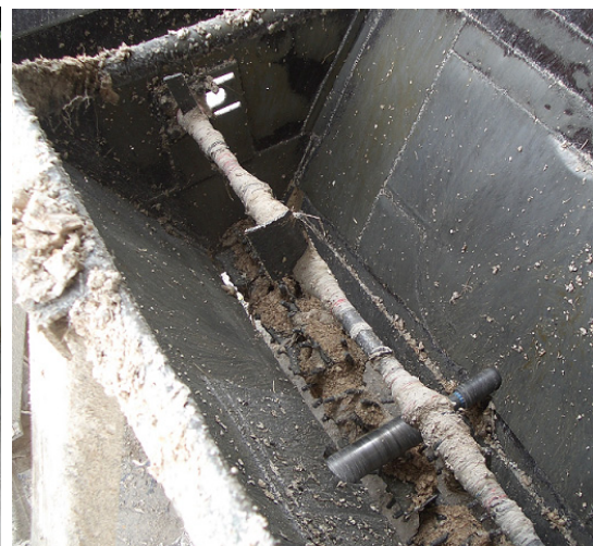
写真 3.11 フィーダー車両開口部
