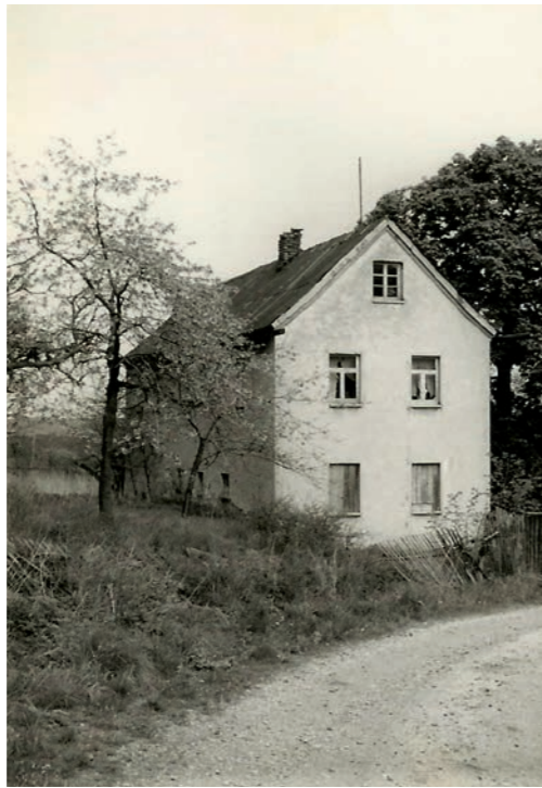
> 1958 erbautes Wohnhaus von Familie Günther in Ebersberg mit ersten Spuren des Verfalls. Nach 1961 Privat
