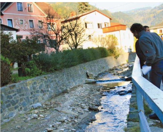
Geschiebeablagerung des Fraßbaches im Mündungsbereich in die Lavant (Frantschach-St. Gertraud, November 2006)
