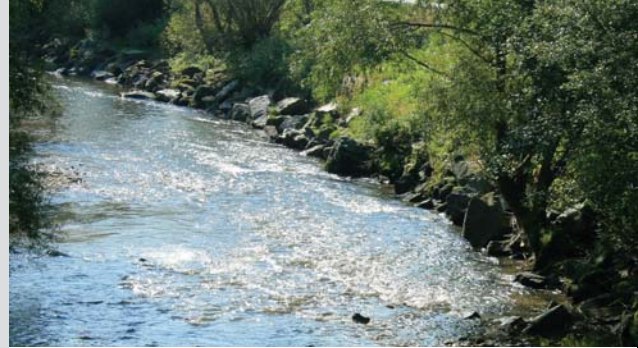
Ansatzsteine in St. Andrä, häufigste Längsverbauung an der Lavant
