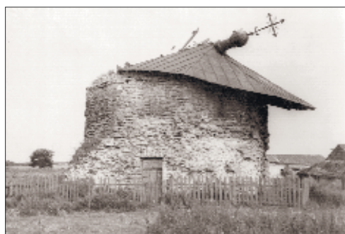
Никольская церковь (Восточный мавзолей) после разрушения ураганом 1965 г.
