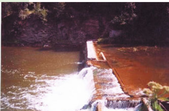
Руины плотины, на дне пруда отчетливо виден лиственный щит от заливания
