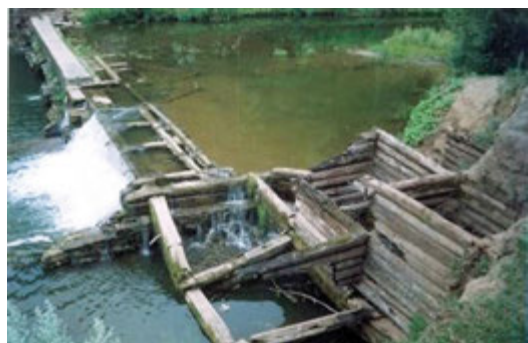
Руины силовых ряжей плотины, по их остаткам и выступам дамбы можно судить о глубине пруда и высоте этого сооружения, по которому шла дорога для развоза двух везов с сеном
