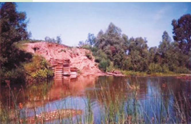
Руины дамбы, видны остатки ряжей (силовые элементы плотины – деревянные срубы, сидящие в воде бывшего пруда)
