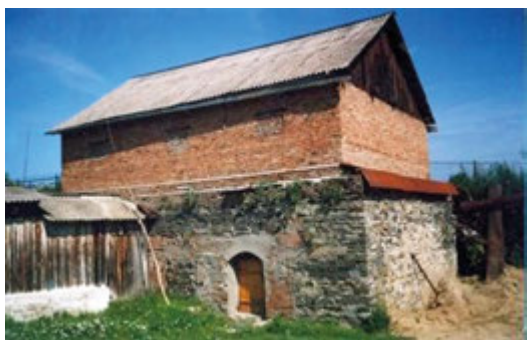
Нижний этаж – машинное отделение жернаковой мельницы, глиной засыпана зона водяного колеса глубиной более пяти метров. Параллельно торцу здания, по лотку, шла вода на водяное колесо. Отсюда же шел отводной канал в р. Порос
