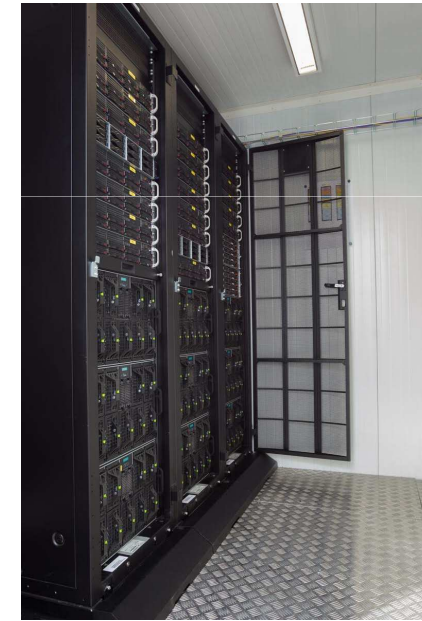
Pohled na tři plně osazené racky (chlazené vodou)
