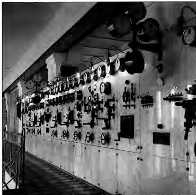
Kraftstationens magnifika manövertavla av marmor med visarinstrument och armatur av mässing. Foto: Bengt Spade 1992.
