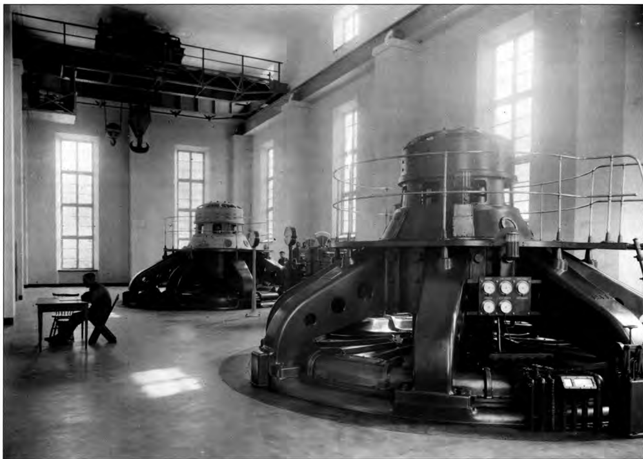
Interiör från maskinsalen i Norrforsstationen. Foto Tor Ekholtz 1 juli 1929. (Vattenfall Mellersta Norrlands arkiv, Umeå.)
