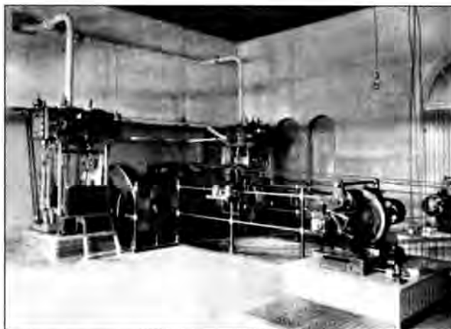
Interiör från ångkraftverket med de båda ångmaskinerna t.v. och två av de fyra remdrivna generatorerna t.h. (Foto ur Umeå stads elektricitetsverk 1892 - 1899 - 1929. Umeå 1929.)
