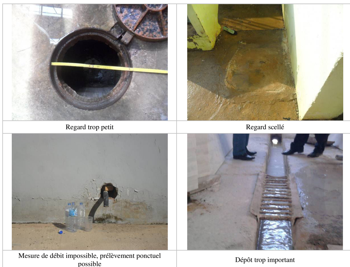
Figure 19 : Planche photographique – Difficultés d'installation rencontrées
