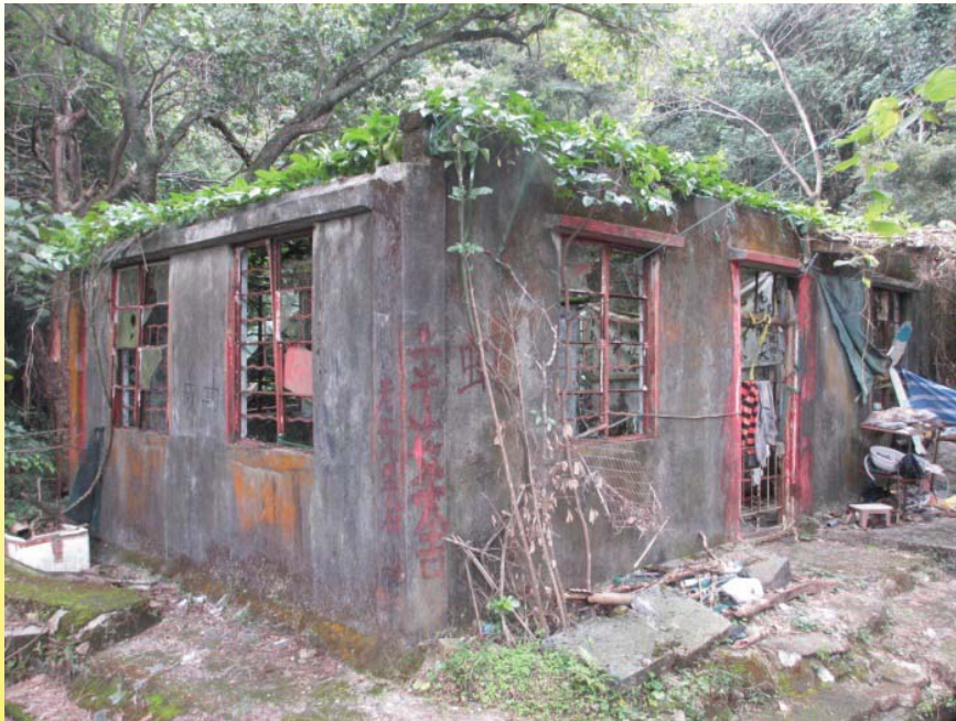
機械室 Engine room
