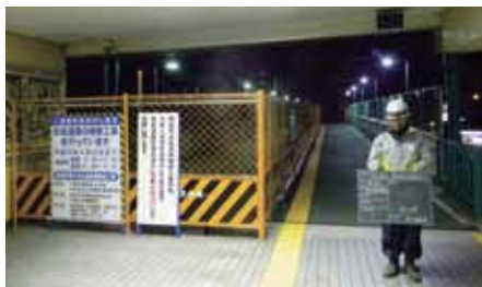
自由通路部ガードフェンス
