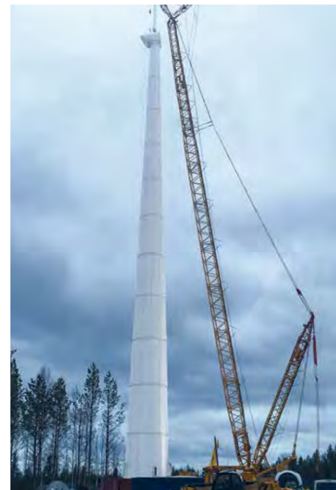
› Der Prototyp der E-147 EP5 steht am Standort Paltusmäki/Finnland vor der Inbetriebnahme.
