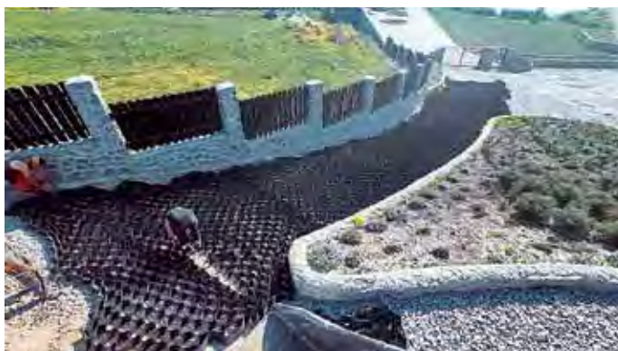
Територія фермерського господарства в Погребищі має відчутний нахил поверхні, тому для зміцнення основи використали геосітку
