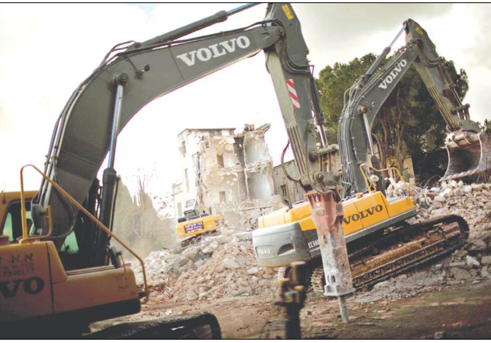
القدس- جرافات اسرائيلية تهدم منزل مفتي فلسطين الحاج امين الحسيني ، فندق شبيرد،
