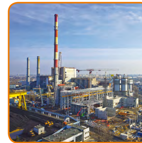
Budowa bloku gazowo-parowego w Ec Żerań. Construction of the gas and steam unit in CHP Żerań.
