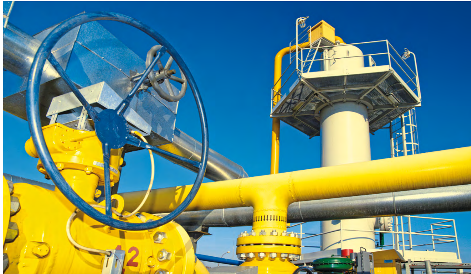
Podziemny Magazyn Gazu Husów. / Husów underground gas storage reservoir.
