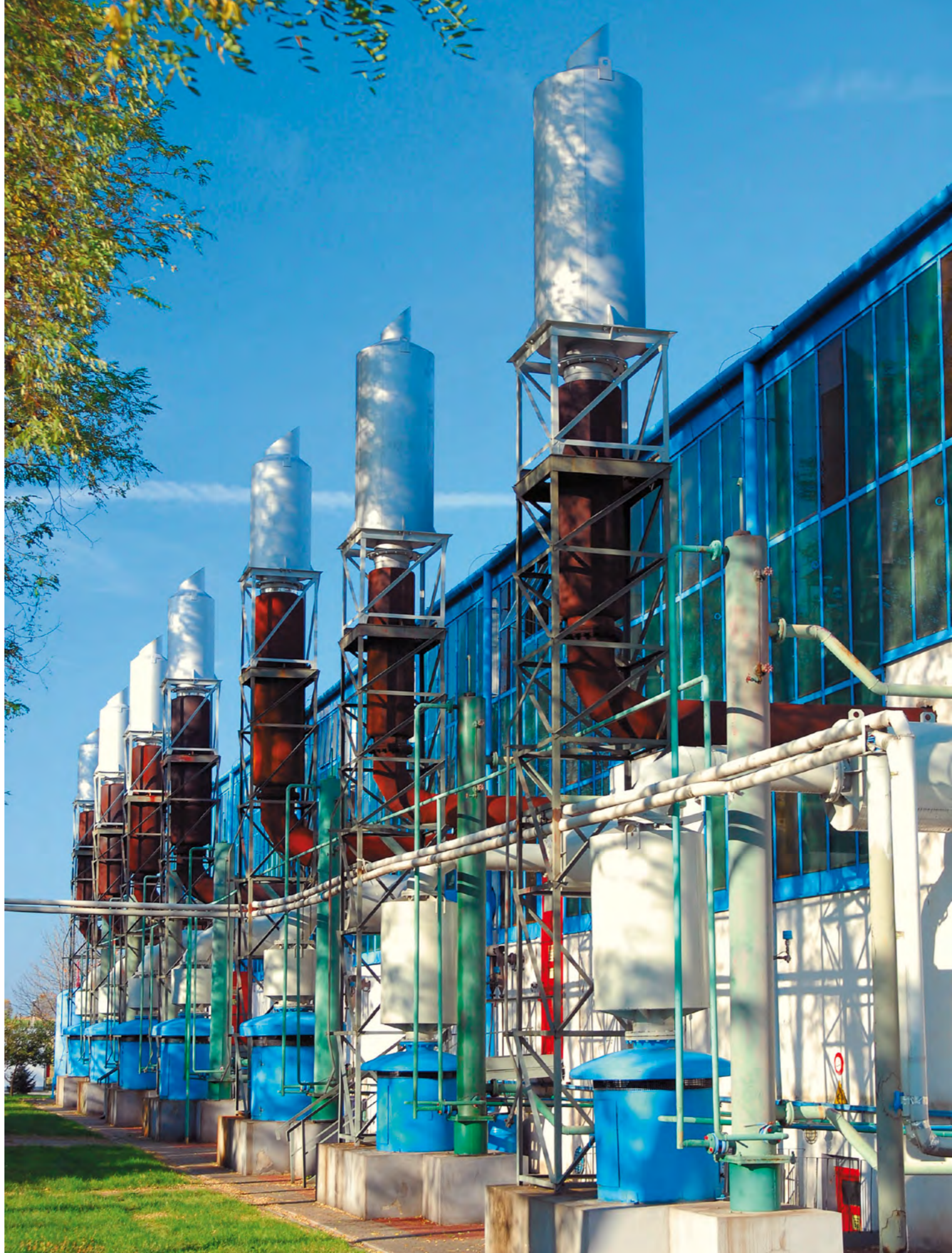
Tłocznia gazu Maćkowice, województwo podkarpackie. / Maćkowice gas compressor station, Podkarpackie Region.
