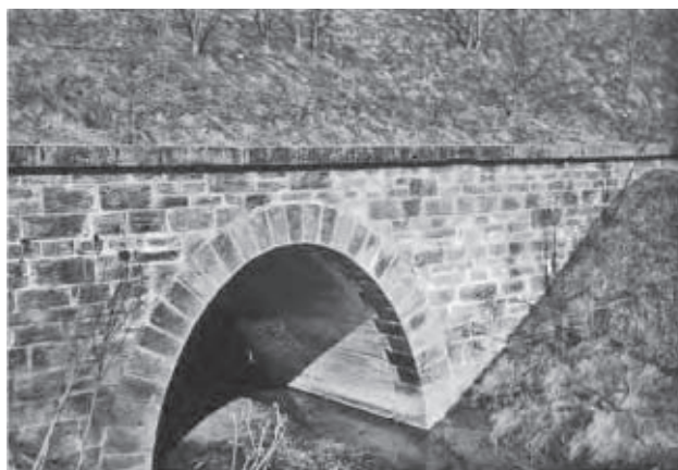
Dálniční most přes říčku Šatavu u obce Ledce (2004) v úseku využitém pro silnici R 52
