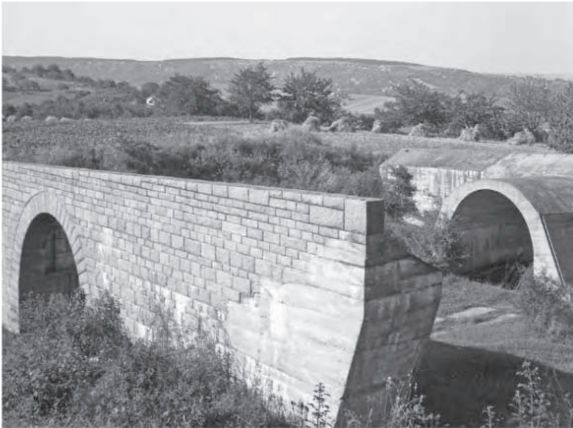
Nedokončený parabolický dálniční most přes polní cestu u Ostopovic (1967), (km 516,7)
