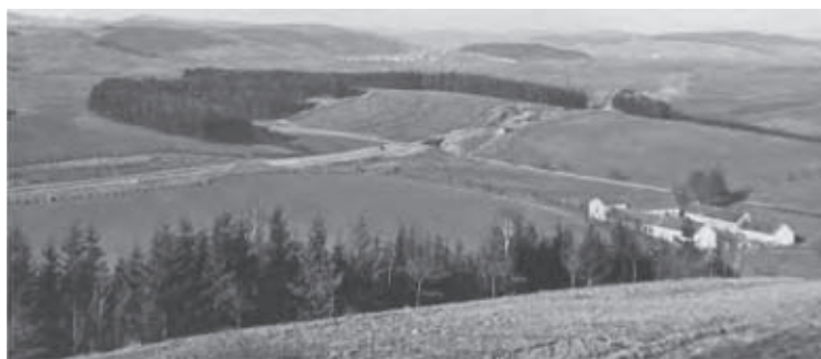
Pohled na stavbu dálnice v místech křížení se silnicí z Černé Hory do Býkovic
