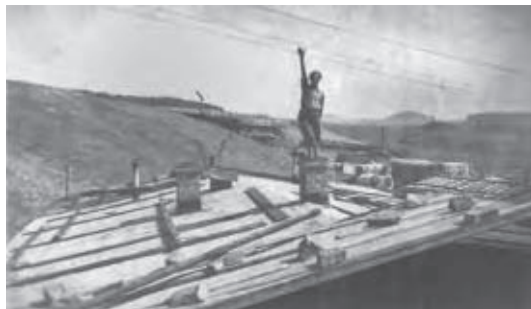
Těleso dálnice a dřevěná konstrukce připravená pro betonáž dálničního mostu přes silnici z Černé Hory do Žernovníka. Vedle dálničního tělesa vidíme dřevěné budovy stavebního dvora firmy Hrabě & Lozovský
