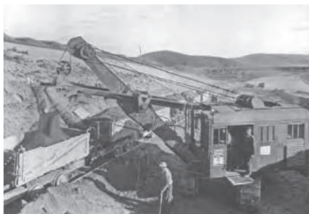
Motorové rypadlo Weserhütte typ W 800 firmy Pittel & Brausewetter na stavbě dálnice u Rozdrojovic (7)
