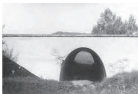
Detail poškození parabolického dálničního mostu (1962), (km 504,2)
