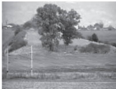
Nedokončený násyp dálnice mezi čebínskou vápenkou a železniční tratí Brno–Havlíčkův Brod (2004), (km 497,5 až 496,8)
