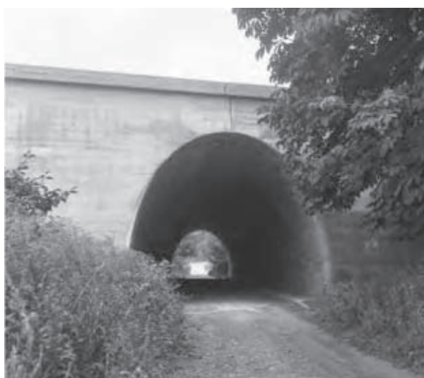
Dálniční most přes místní komunikaci a potok – pohled na klenbu mostu (1986), (km 521,4)
