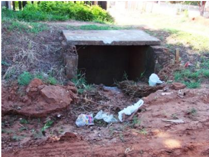
FIGURA 40: BOCA DE LOBO: RUA SANTA CATARINA
