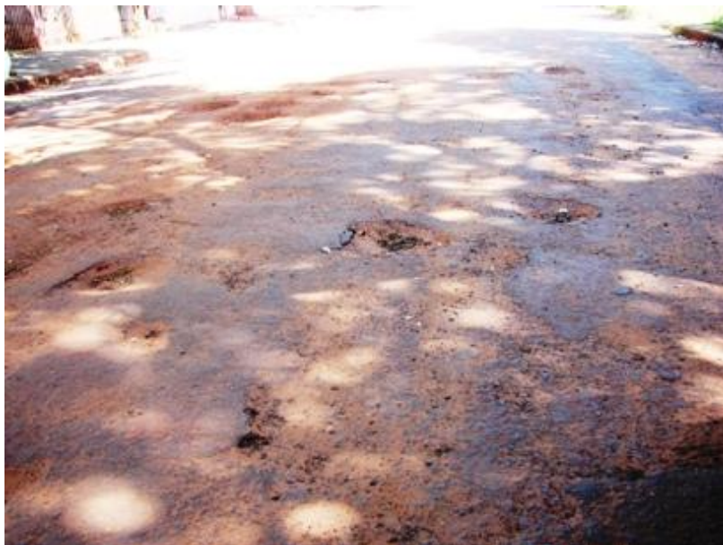
FIGURA 56: PAVIMENTAÇÃO ASFÁLTICA COM BURACOS
