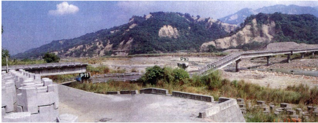
照片8.2.2-11 投53線龍門大橋受損情形
