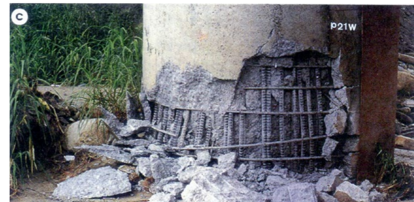
照片8.2.2-9 台3線名竹大橋橋墩受損情形之二
