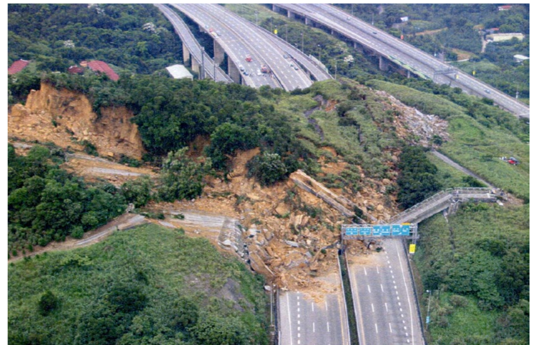
照片8.6.2-1 國道3號3.1K大坍方空照圖
