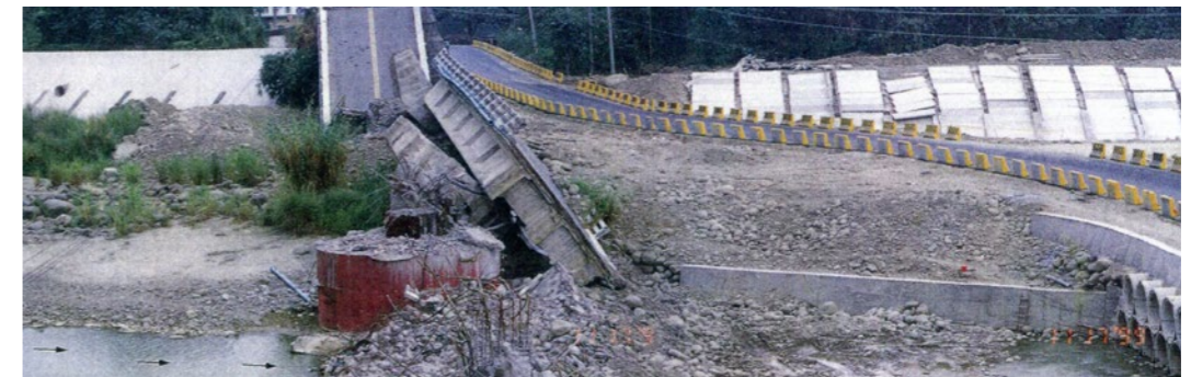
照片8.2.2-10 149線桶頭橋落橋情形
