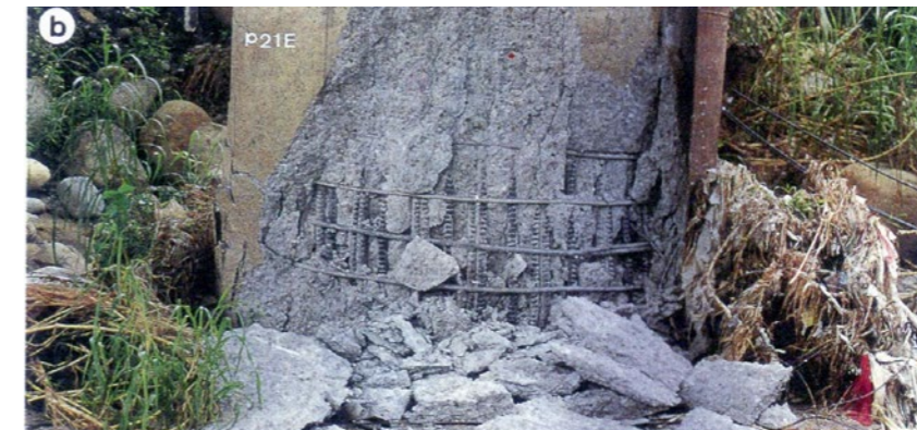
照片8.2.2-8 台3線名竹大橋橋墩受損情形之一
