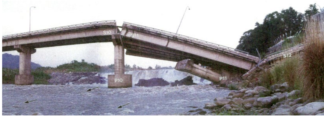
照片8.2.2-3 埤豐大橋P11斷裂傾倒情形
