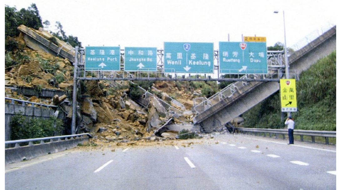
照片8.6.2-2 國道3號3.1K大坍方現場圖
