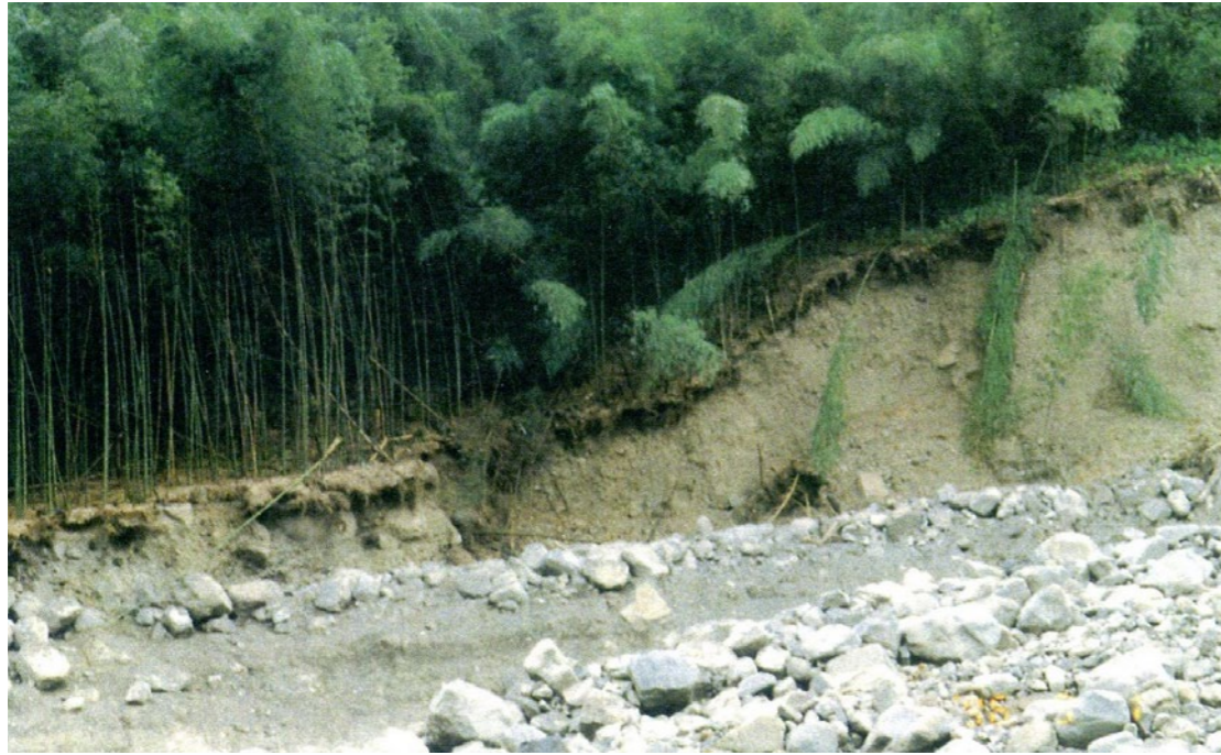
照片8.3.2-1 出水溪下游靠近神木國小附近河段趾崩塌情形
