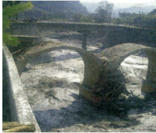
照片8.4.2-9 台21線北港溪橋受糯米橋通洪阻礙
