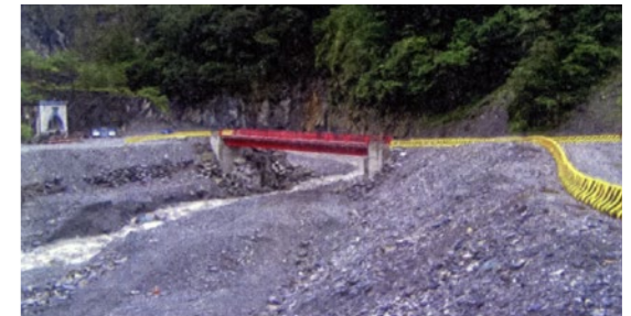
照片8.5.3-13、14、15 利稻橋災前災後狀況，從上至下災前→災後→修復鋼便橋
