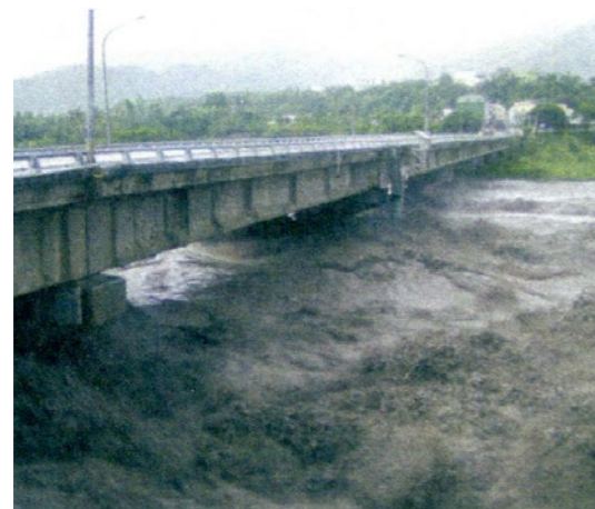
照片8.4.2-1 荖濃溪六龜大橋上游洪水狀況
