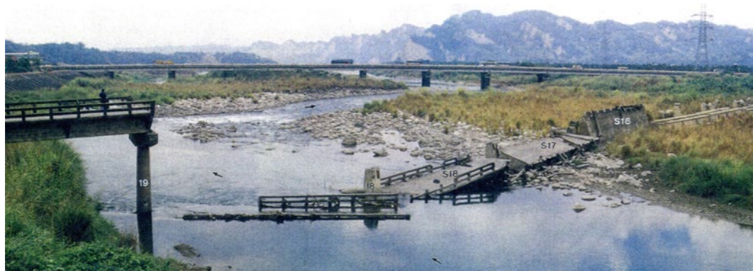
照片8.2.2-5 平林橋左岸附近橋梁震害情形
