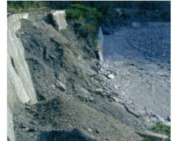
照片8.4.2-4 台20線101K+500災損情形
