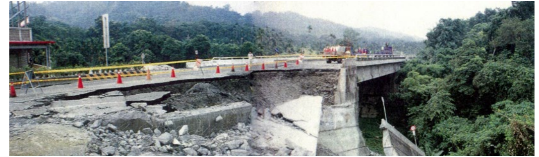
照片8.2.2-7 台16線磨坑二號橋引道損毀情形
