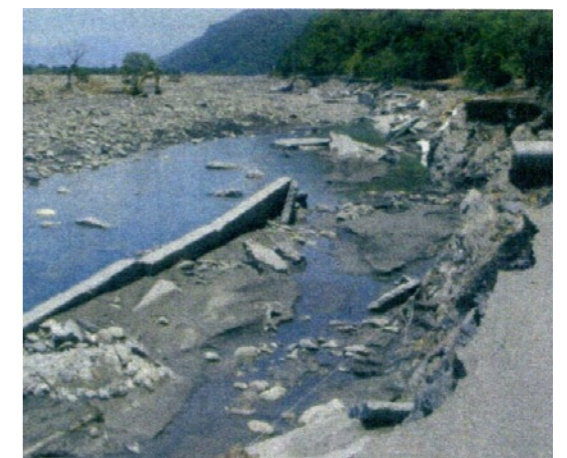
照片8.4.2-6 台27線20K+200~915災損情形
