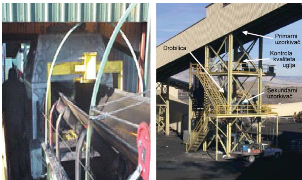
Slika 2.35. On-line (levo) i off-line (desno) analizatori montirani na traci
