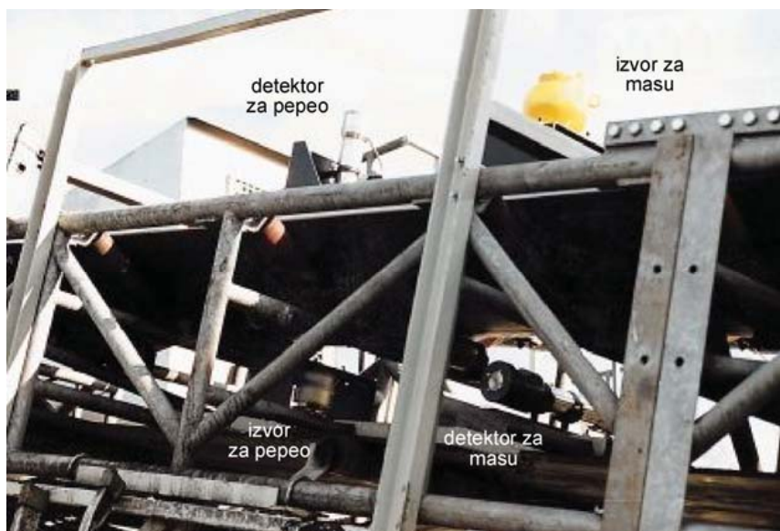
Slika 2.39. Izgled analizatora za pepeo montiranih na transportnoj traci
