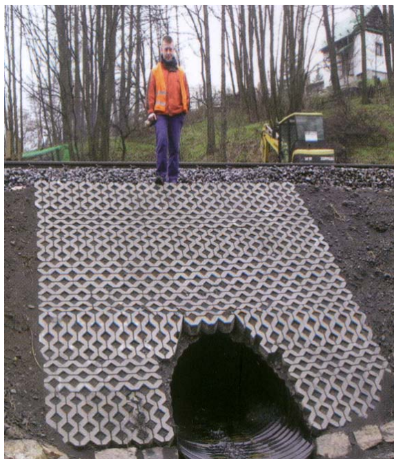
Fig. 2.10 Execuția unui podeț din tablă zincată ondulantă ce susține o cale ferată
