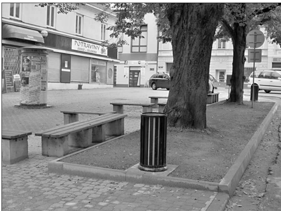
Oprava horní části náměstí u gymnázia. Chybí pouze doasfaltování okrajů vozovky. Foto: M. Drtina
