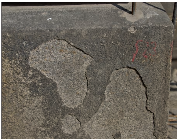
Abb. 7: Schalenbildung an Lausitzer Granit im Sockel des Gebäudes der Kunstakademie.
