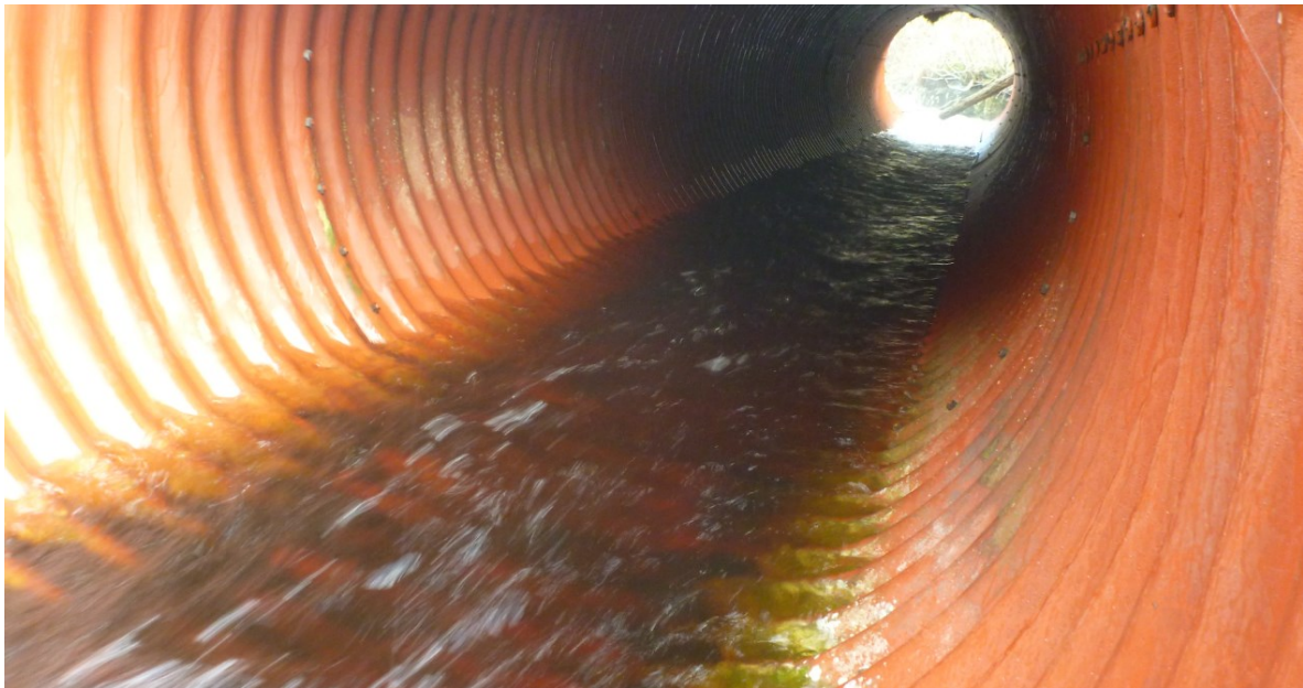
Figur 73. Kulvert under Fv 723 på høy vannføring i Bubekken. Foto: Morten Bergan.
