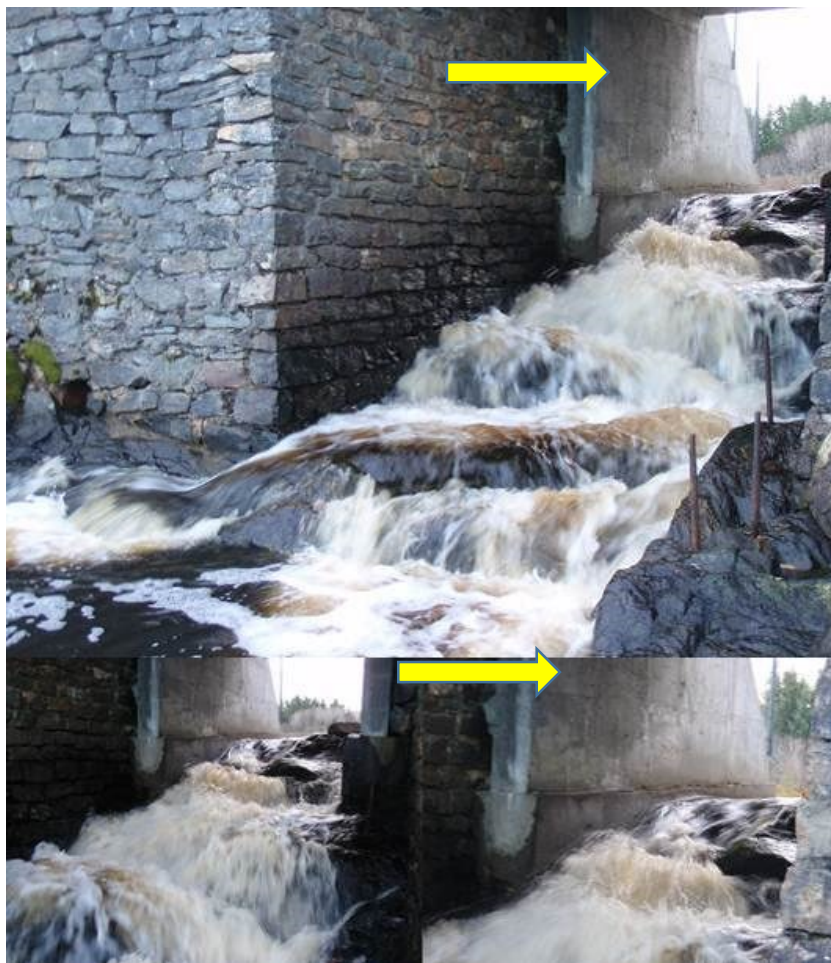
Figur 95. Sterkt vandringshindrende veikrysning under Fv 381. Nylig murt betong langs den ene kulvertensiden (gul pil) har avsmalnet elveløpet, gitt enda høyere vannhastighet og forverret oppgangen ytterligere. Sjørretbestanden i vassdraget kan være tapt. Foto: Morten Bergan.
