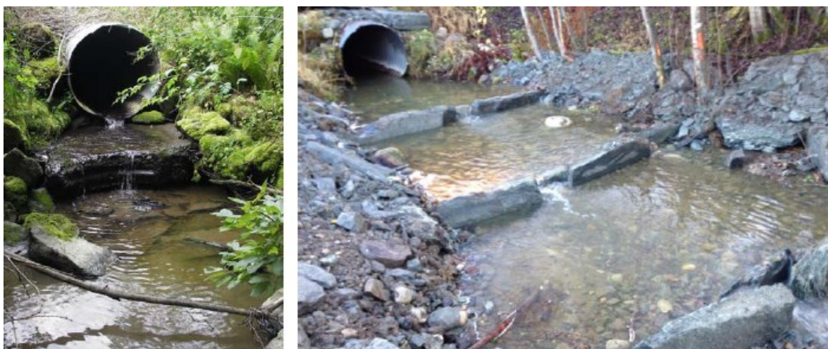
Figur 15. Før (2006, t.v) og like etter (2012, t.h.) tiltak ved veikrysningen under FV 707 i Buskleinbekken. Foto: Morten Bergan /Trondheim kommune.
