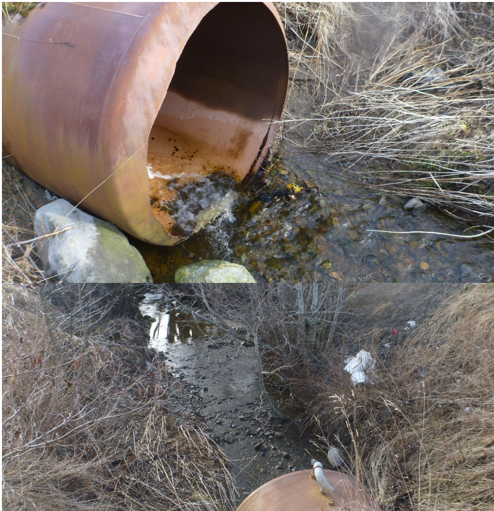
Figur 83. Innløp til lukket strekning like oppstrøms Fv 710 (øverst), der en meget fin og godt egnet sjøørretbekk befinner seg oppstrøms dagens problemområder. Foto: Morten Bergan.
