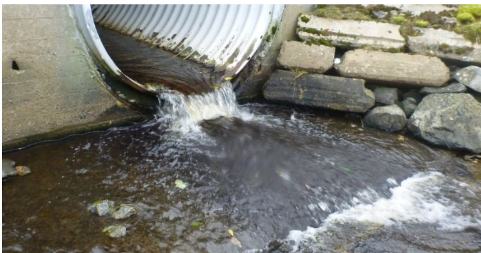
Figur 59. Fall på steinplate i kulverten under Fv 15. Høyre kulvertløp sett nedenfra og opp Bessakerelva. Foto: Morten Bergan.
