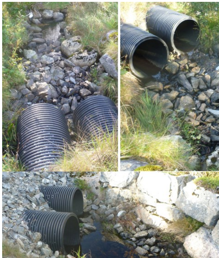
Figur 103. Veikrysning under Fv 716 i bekk fra Ytter Singsvatnet /Ytter Røssvatnet. Foto: Morten Bergan.
