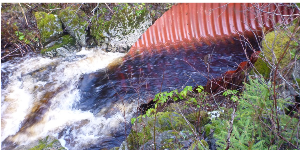
Figur 72. Kulvert under Fv 723 på høy vannføring i Bubekken. Foto: Morten Bergan.
