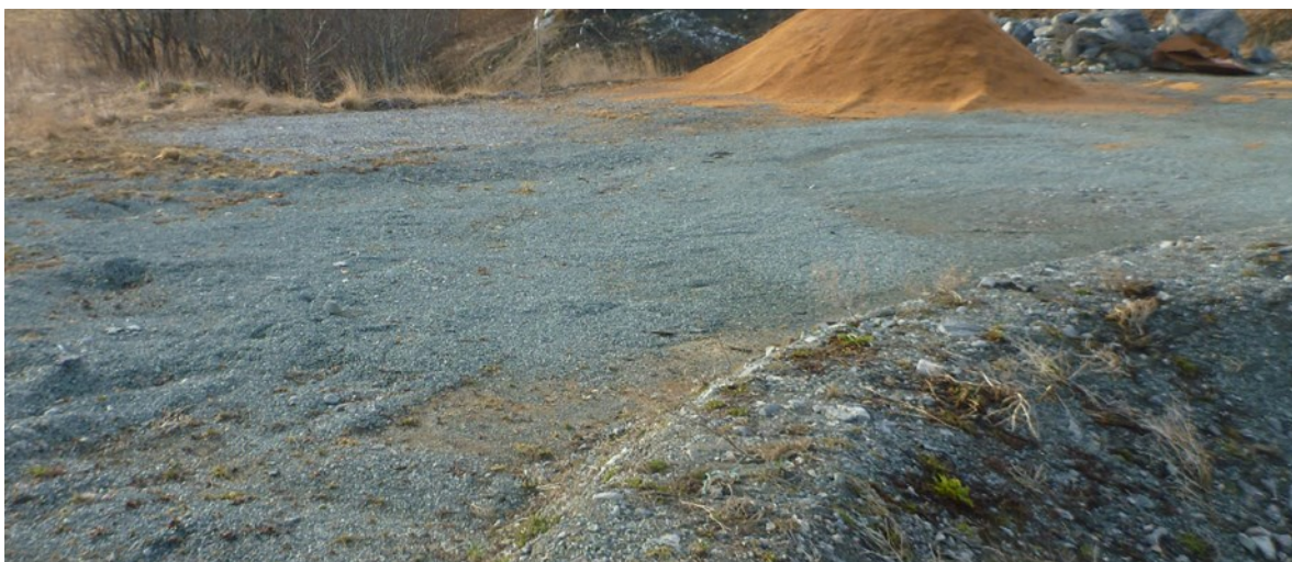
Figur 82. En lengre strekning der bekken går i kulvert med ukjent status bare noen meter oppstrøms FV 710. Foto: Morten Bergan.
