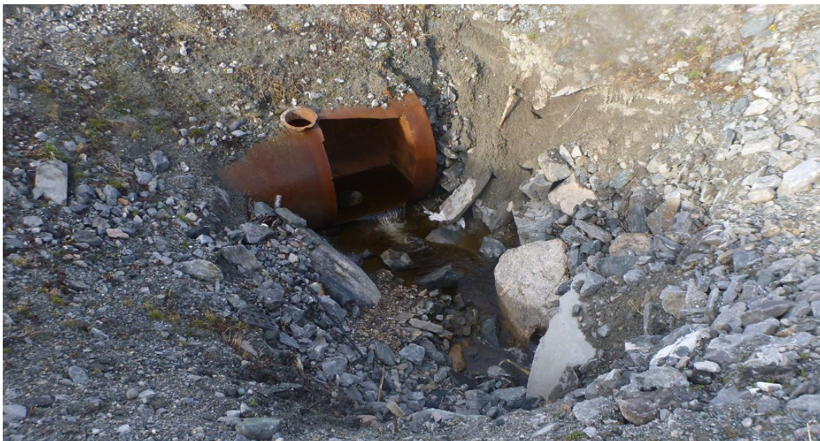
Figur 81. Kun et par meter av bekken går i dagen oppstrøms kulverten under Fv 710. Foto: Morten Bergan.
