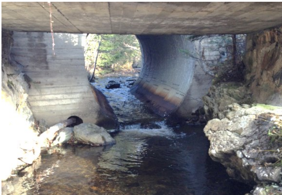
Figur 52. Kulvert under Fv 963 i Lauva til Vikaelva er vandringsbegrensende på vannføring under middels. Bekken er antatt svært viktig for vandrende ørret tilhørende Foldsjøen. Foto: Morten Bergan.
