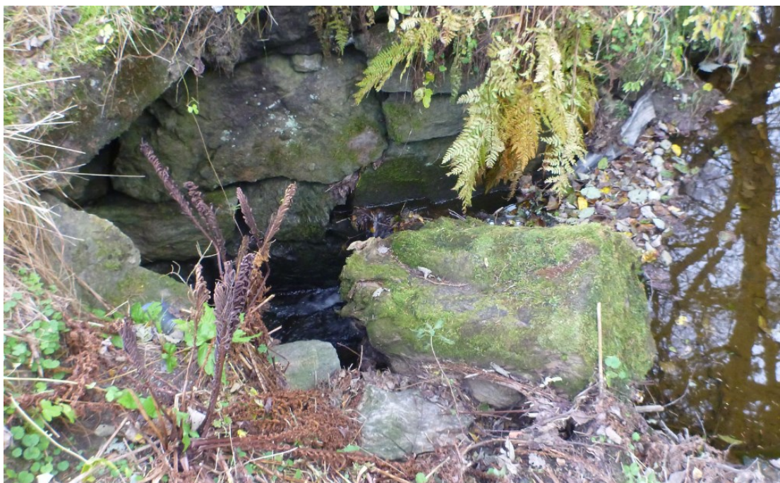
Figur 37. Problempunkt ved veikrysningen av Fv 30 i Marbekken. Foto: Morten Bergan.
