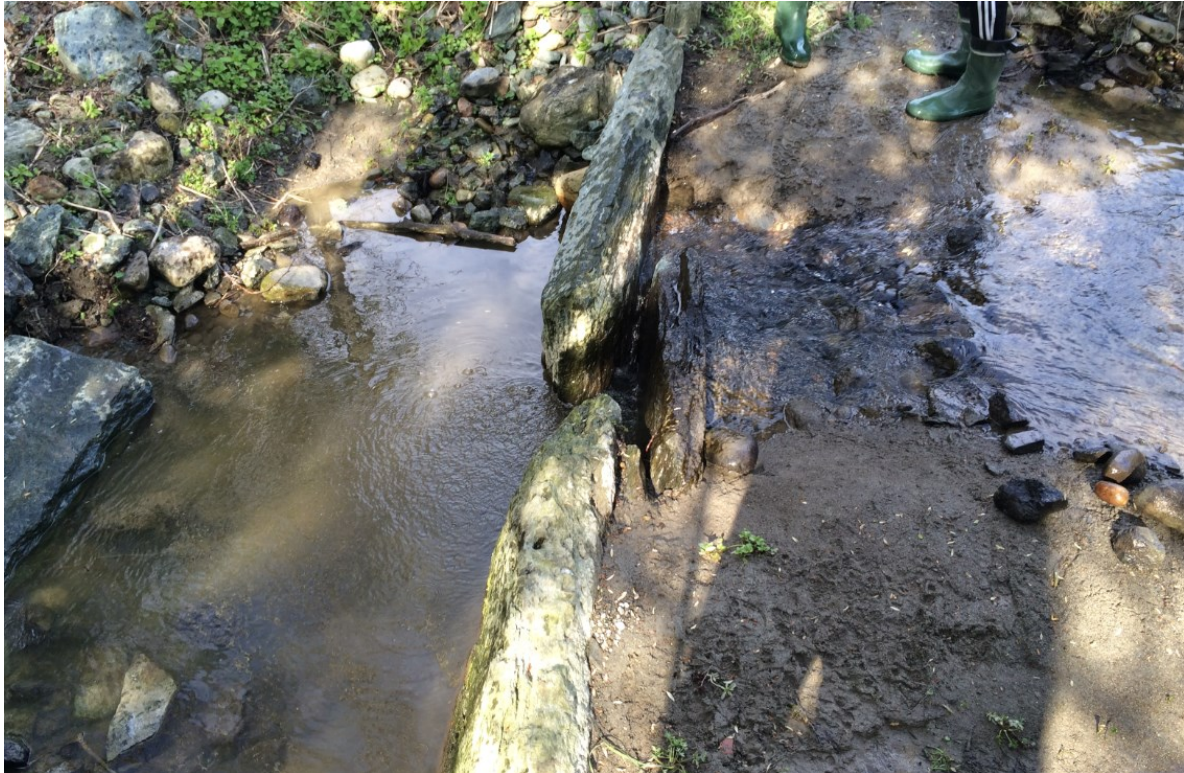
Figur 16. Nederste terskel ved befarings i mai 2015. Mangel på dyp satskulp nedstrøms terskel, og gjenøring av kulper ifbm tersklene. Foto: Morten Bergan
