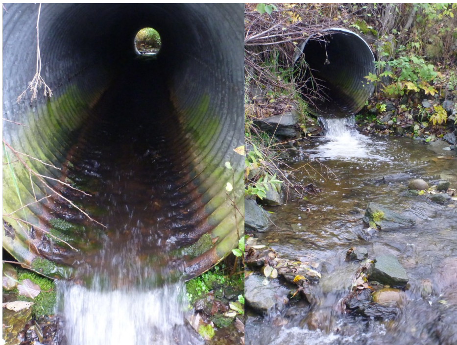
Figur 22. Veikulvert under Fv 707 høsten 2013, etter tiltak. Fortsatt noe høydeforskjell og høy vannhastighet gjennom kulverten. Foto: Morten Bergan.
