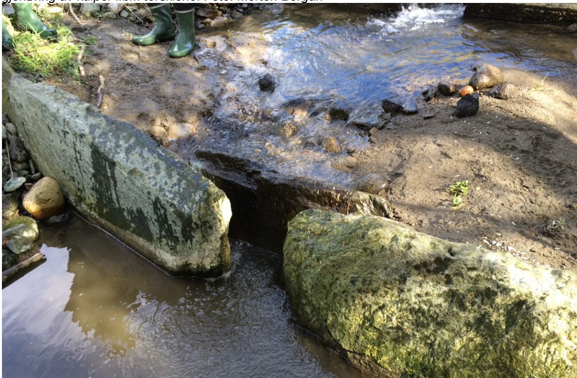
Figur 17. Nederste terskel ved befarings i mai 2015. Mangel på dyp satskulp nedstrøms terskel, og gjenøring av kulper ifbm tersklene. Foto: Morten Bergan
