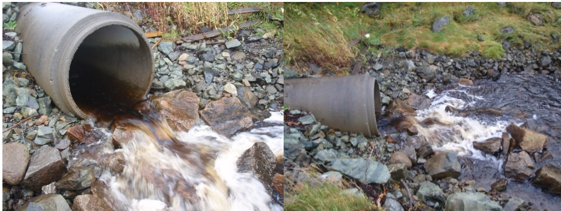
Figur 84. Kulvert under Fv 713 i Fløsvassdraget munner noen meter oppstrøms normal flosone, og har flere storstein liggende foran kulvertutløpet. Veikrysningen må utbedres. Foto: Morten Bergan
