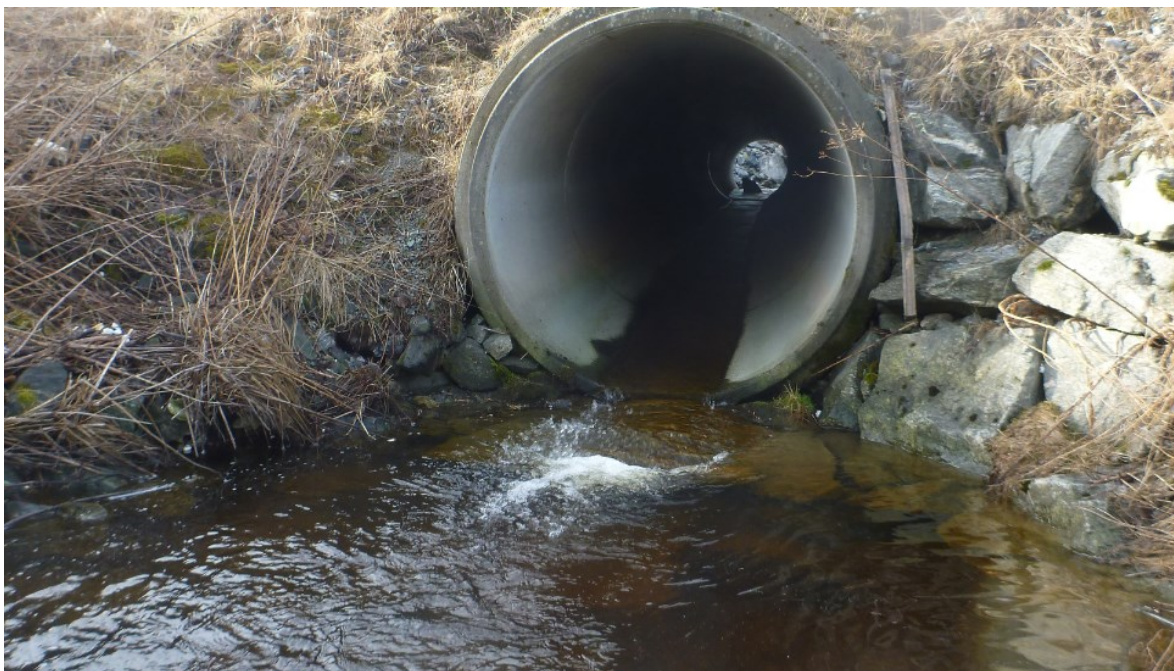
Figur 80. Ingen steinplate som stopper inngangen til kulvertutløpet i mars 2015, på lav vannføring i bekken, men veikrysningen er fortsatt sterkt vandringshindrende pga lengde, lavt vanddyb og høy vannhastighet. Inngrepet må sannsynligvis utbedres for fiskevandring, men ungfisktelling bør utføres først. Foto: Morten Bergan.
