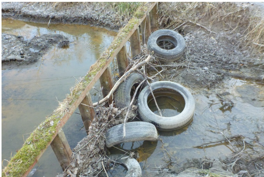
Figur 40. Nedslamming og tendens til tiltetting ifbm kulverter under både jernbane og Fv 630 i Enganbekken. Foto: Morten Bergan.
