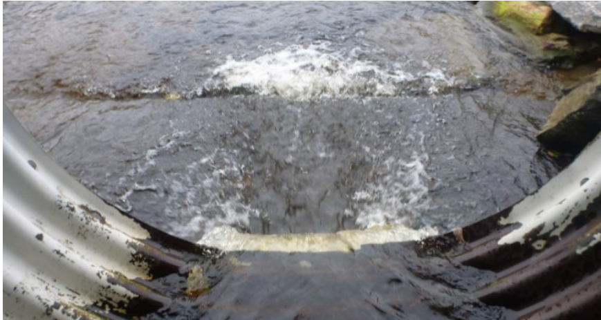
Figur 60. Fall på steinplate i kulverten under Fv 15. Motsatt kulvertløp fra foto oppstrøms. Foto: Morten Bergan.
