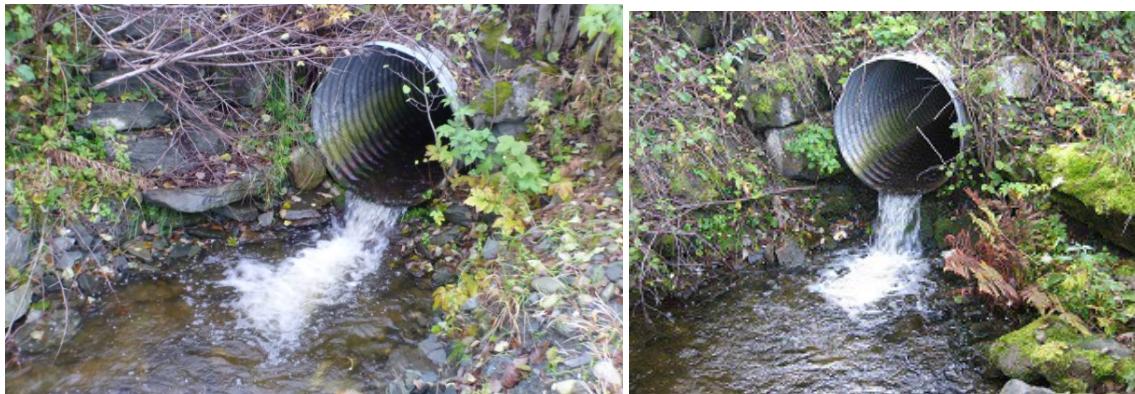
Figur 21. Veikulvert i 2013 etter tiltak (t.v.) og i 2011 før tiltak (t.h.). Høydeforskjellen mellom kulp og kulvert er redusert noe, men sjørret har foreløpig ikke passert veikulverten. Foto: Morten Bergan.
