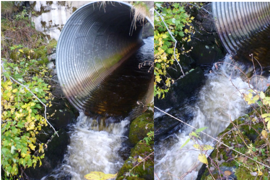
Figur 62. Kulvert under Fv 196 Denstadveien i Mobekken. Foto: Morten Bergan.
