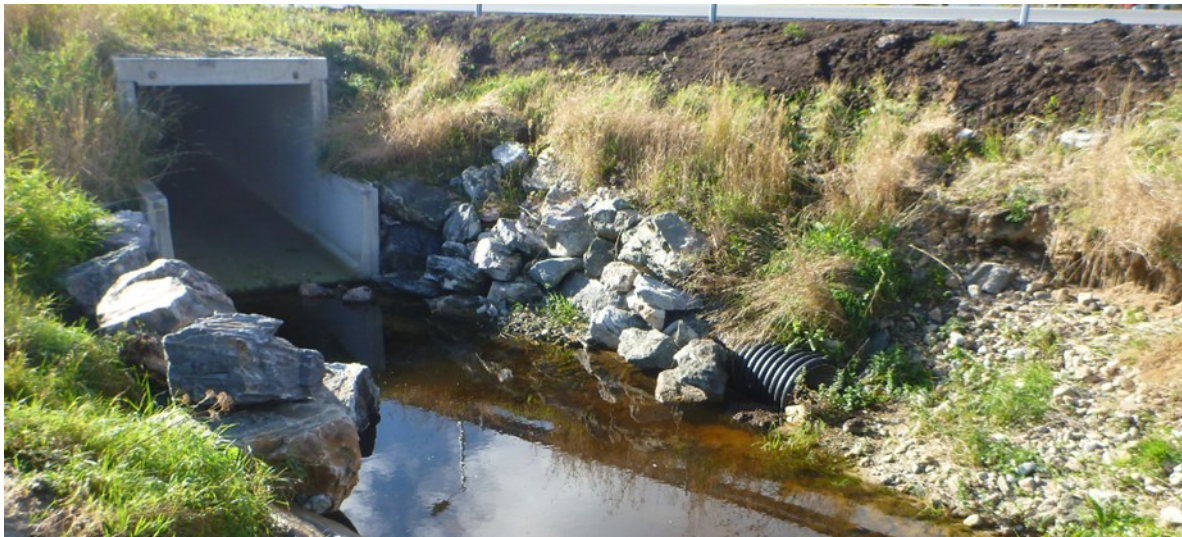
Figur 99. Veikulvert under Fv 714 vi Ervikelva er helt ny, men er ikke fiskeførende på de fleste vannføringer i vassdraget. Foto: Morten Bergan.
