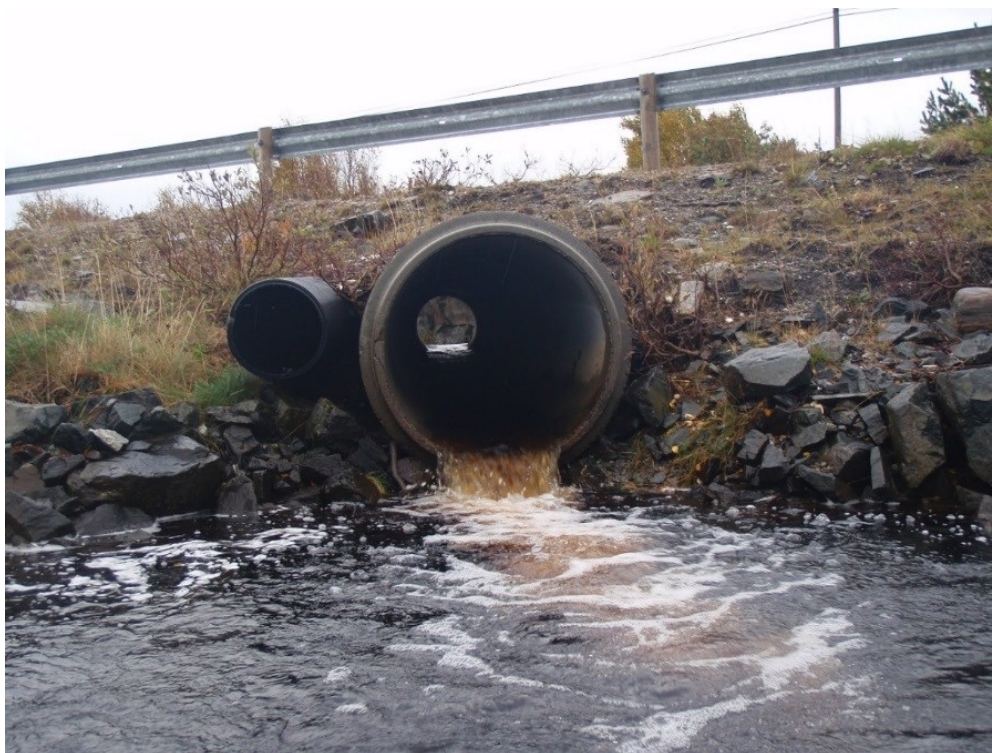
Figur 86. Kulvert under Fv 713 i utløpsbekken til Littsandvatnet. Foto: Morten Bergan.
