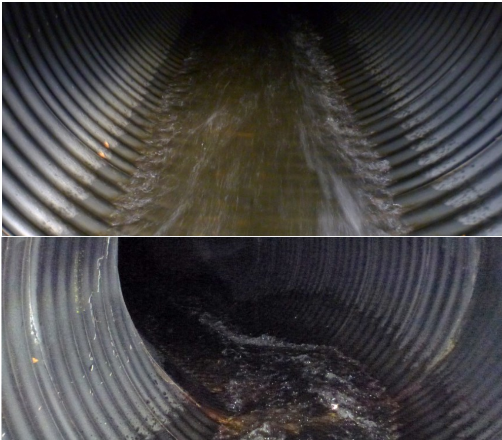
Figur 48. Øvre del av kulvert ifbm. Fv 950 (nr. 87) i Vikhammerelva. Foto: Morten Bergan.
