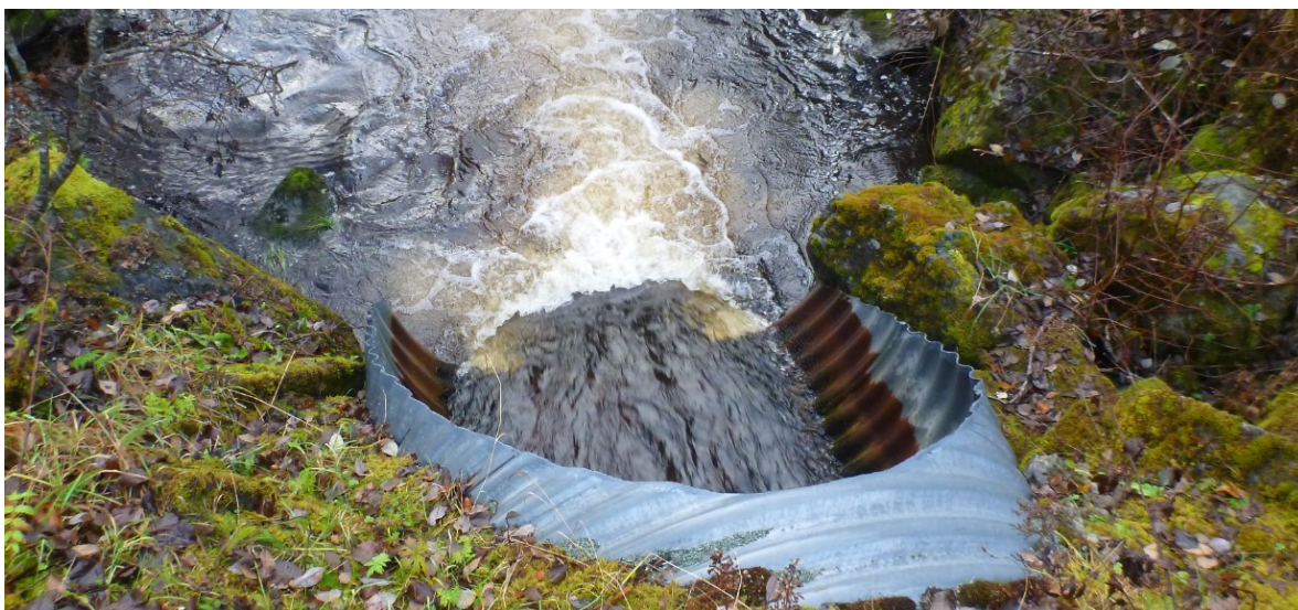
Figur 70. Kulvert under Fv 721 i Okla, på vannføring som antas å være fiskeførende for veikrysningen. Foto: Morten Bergan.
