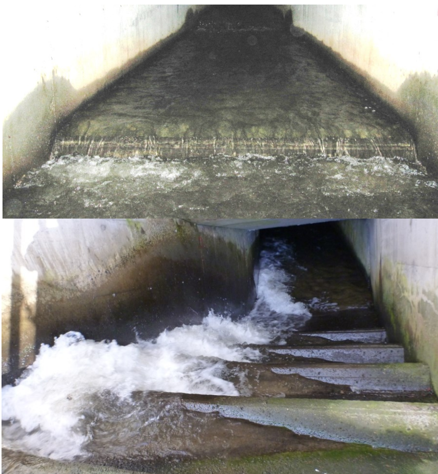
Figur 50. Øverst: Innside av kulvert under EV 6. Nederst: Øvre del og uhensiktsmessige terskler for fiskevandring i kulvert under EV 6 (nr. 3) i Vikhammerelva. Foto: Morten Bergan.
