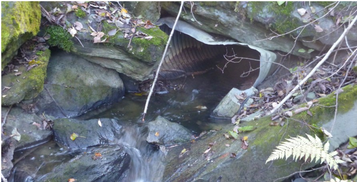
Figur 33. Nedsida av Fv 672 og utgang av veikulvert i Lera. Foto: Morten Bergan.
