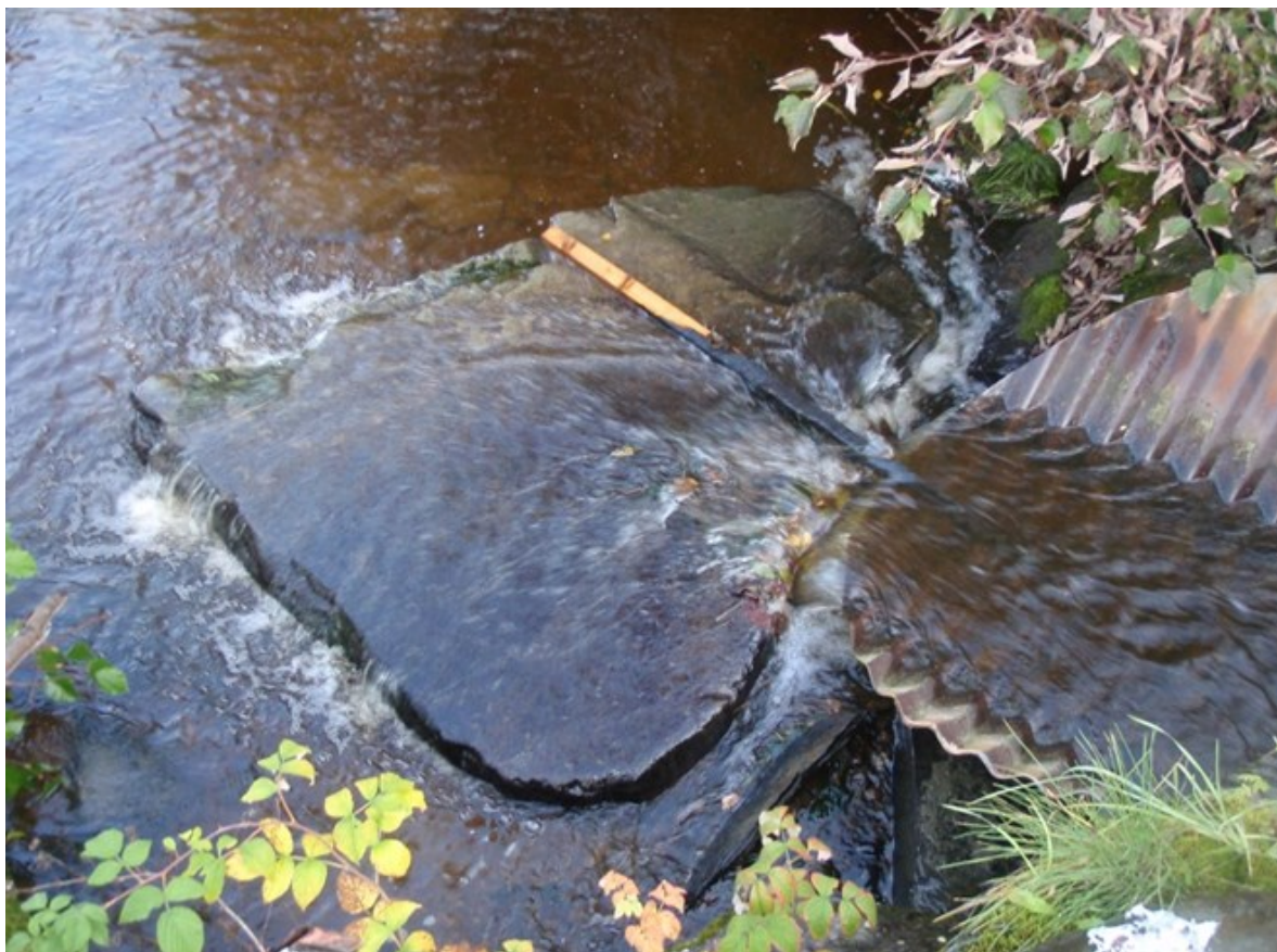
Figur 2. Kulvert under EV 6 i Lynga før tiltak i 2014. Foto: Morten Bergan.
