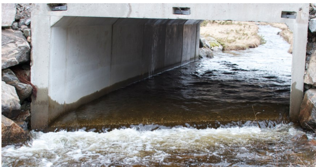
Figur 94. Veikrysning under Fv 716. Høye vannføringer som på befaringstidspunkt gir oppvandringsmuligheter for både sjørret og ål. Foto: Morten Bergan.
