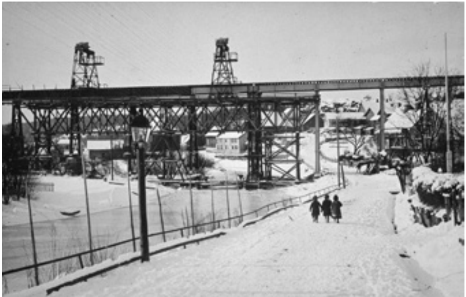
Parti fra Store Strandgate vinteren 1914 ved ombygging av viadukten. To store portalkraner er i arbeid, og de to pilarene nærmest veien er trolig skiftet ut. Under portalkranen til høyre ses det gamle kvartalet Titut som ble revet i 1938. I forgrunnen står en gasslykt. (Fra Helge Holters samling).
